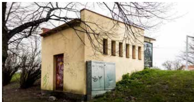
Sähkömuuntoasema Aittarannan pohjoisosassa, Itäranta 14:ssä.
