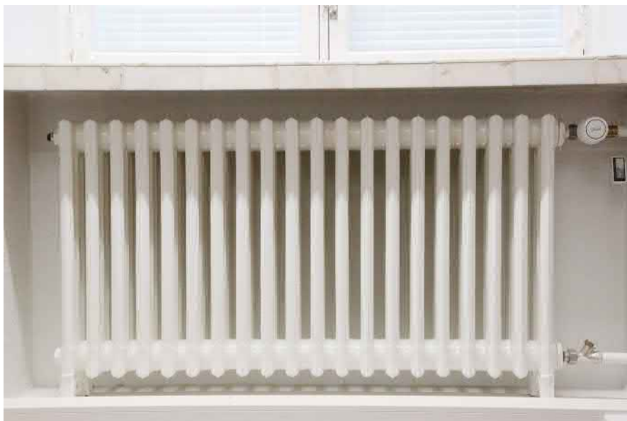
Alkuperäinen, kunnostettu lämmityspatteri.
