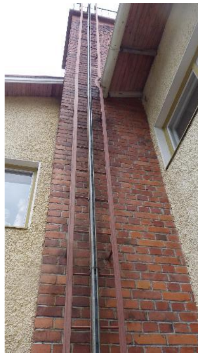
Kuva 5.12.6. Savupiipun tikkaat on varustettu turvakiskolla.
