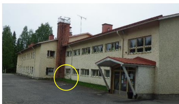
Kuva 5.9.3. Ulkoseinän maalipinnassa paikallisia vaurioita.
