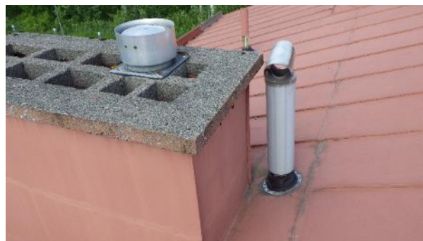
Kuva 6.6. Tiilihormiin yhdistetty poistopuhallin palvelee veistosalia ja wc-tiloja.
