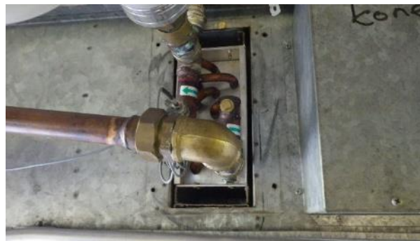
Kuva 6.4. Tuloilmakojeen lämmityskennon ja rungon liitosta ei ole tiivistetty.
