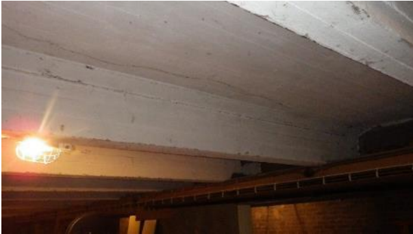
Kuva 5.6.5. 1-kerroksen välipohjarakenteen (VP3) alapuoli entisen halkovaraston kohdalla. Laatassa näkyy halkeama.
