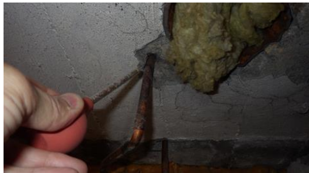
Kuva 5.18.4. Välipohjan epätiivis läpivienti autotalissa.
