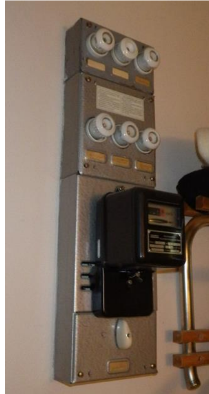
Kuva 6.18. Opettajaintiloissa oleva sähkötäulu.
