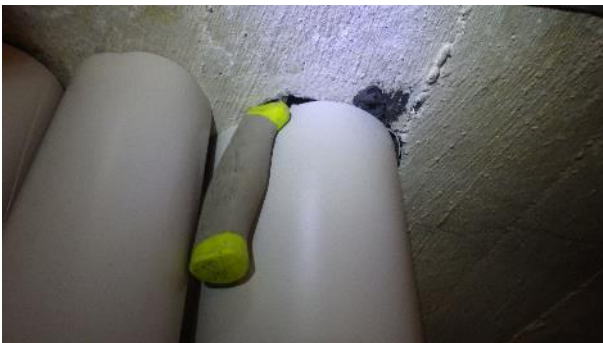
Kuva 5.18.3. Epätiivis putkiläpivienti autotalissa.
