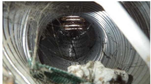
Kuva 5.17.6. Kellarin seinässä oleva ilmanvaihtoaukko on putkitettu osin ruttuputkella.
