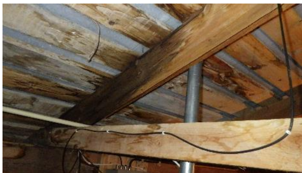
Kuva 5.13.3. Katossa ollut vesivuoto antenniputken juurialueelta (paikattu).
