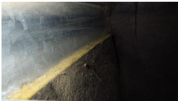
Kuva 6.3. IV-koneen jakokammion äänenvaimentimet ovat pinnoitettua mineraalivillalevyä. Reunoja ei ole pinnoitettu.
