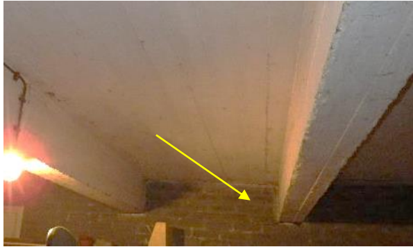
Kuva 5.2.7. Perusmuurin sisäpuoleisessa tiiliverhouksessa vaakahalkeamia palkkien alapuolella.
