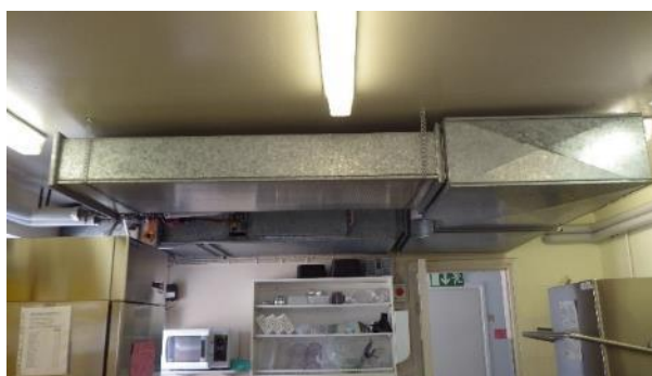
Kuva 6.1. Keittiössä oleva tuloilmakoe.
