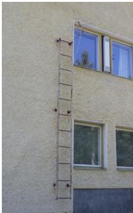
Kuva 5.12.5. Koillispäädyn palotikkaissa on ruostevaurioita
