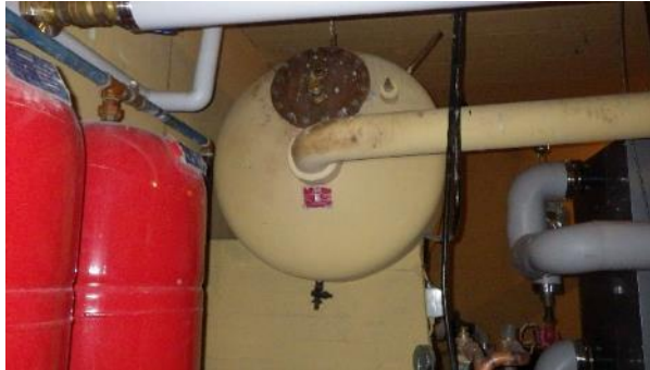
Kuva 6.11. Alkuperäinen lämminvesivaraaja. Eristetty asbestipitoisella eristeellä.
