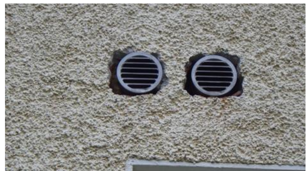
Kuva 5.17.12. Veistosalin kohdalla olevat IV-ritilät. Läpiviennit ulkoseinässä ovat tiivistämättä.
