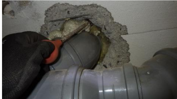
Kuva 5.18.2. Välipohjan epätiivis läpivienti autotalissa.
