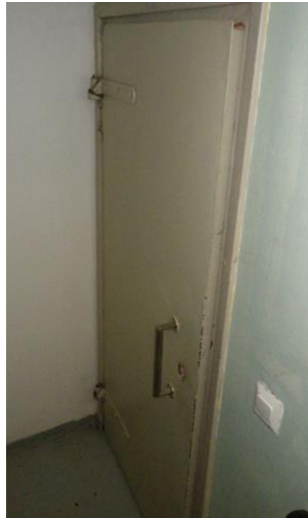
Kuva 5.14.4. Kellarin ja porrashuoneen välinen palo-ovi.
