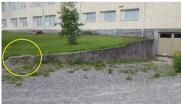
Kuva 5.2.9. Kellarin sisäänkäynnin maanvastaisen tukimuurin kulma on vaurioitunut.
