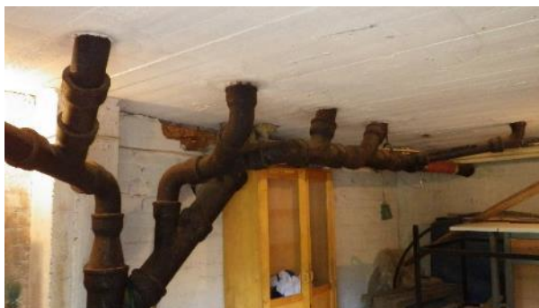
Kuva 6.7. Autotallissa näkyvät valurautaviemärit.
