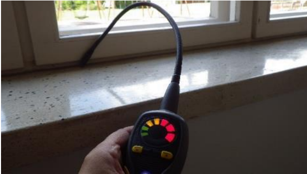
Kuva 5.18.1. Oppilaseteisen ikkunakarmin ja ikkunapenkin liitoksessa on ilmayhteys eristetilaan.
