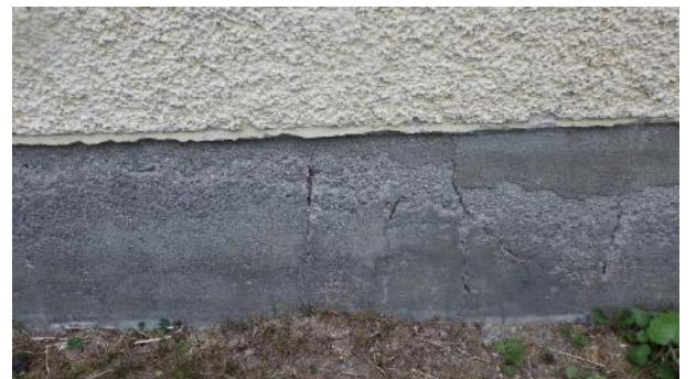
Kuva 5.2.6. Sokkelin pinnalla on näkyvissä valuaikaisia kiviaineksen erottumajälkiä sekä pystysuuntaisia halkeamia.
