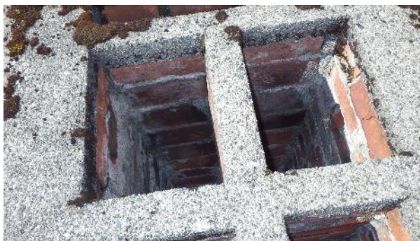
Kuva 5.17.1. Tiilihormin ylimmissä tiilivarveissa on alkavaa rapautumista.
