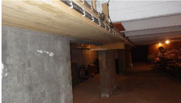
Kuva 5.17.9. Kellarin katonrajassa sijaitsee puuraken- teiset lämpöjohtokotelot.
