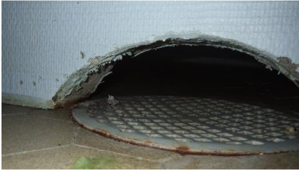
Kuva 5.14.1. Pesuhuoneen tiiliväliseinän alaosan vedeneriste on puutteellinen.
