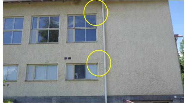
Kuva 5.9.5. Julkisivussa paikallisia halkeamia.
