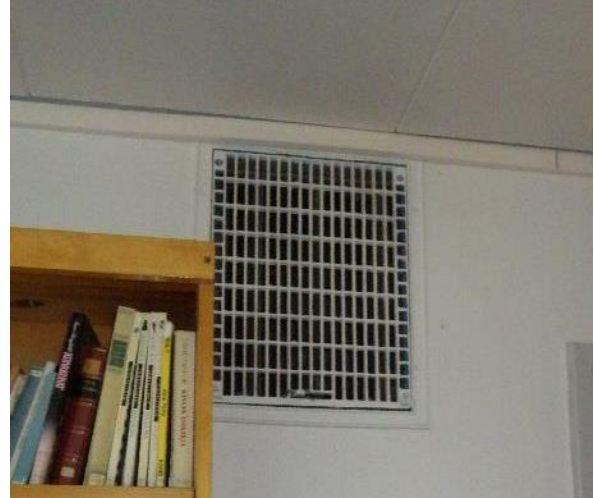
Kuva 5.17.4. Luokkien ilmanvaihto toimii painovoimaisesti tiilihormien kautta.
