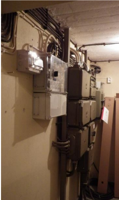
Kuva 6.17. Kellarissa oleva sähköpääkeskus.
