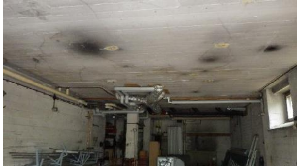
Kuva 5.6.6. 1-kerroksen välipohjarakenteen (VP1) alapuoli autotallissa. Alalaatassa on vanhoja kosteusvauriojälkiä.
