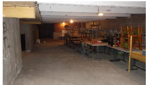
Kuva 5.15.10. Kellarin lattiapinnat on suurelta osin maalaamattomia betonilattioita.
