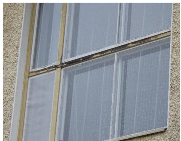
Kuva 5.10.2. Juhlasalin ikkunoiden ulkopuitteessa on havaittavissa lahovaurioitumista.
