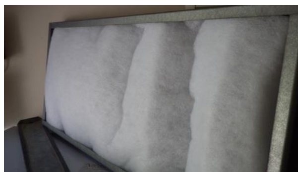
Kuva 6.2. IV-koneen suodatin on puhdas.
