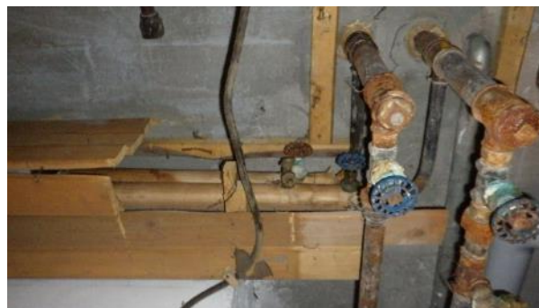
Kuva 6.8. Lämpöjohdot ovat alkuperäisiä. Muviliitoksissa pintaruostetta.
