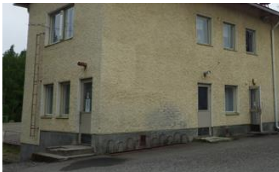
Kuva 5.8.1. Koillispäädyn päätysisäänkäynnin ulkoportaat ovat huonokuntoisia.
