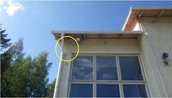
Kuva 5.9.4. Julkisivussa paikallinen halkeama.
