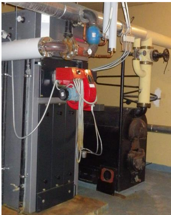
Kuva 6.13. Öljylämmityskattila on asennettu v. 1989. Puulämmityskattila on alkuperäinen.
