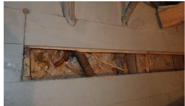
Kuva 5.3.4. Alapohjarakenne sähköpääkeskuksessa. koolausvälissä on orgaanista jätettä.
