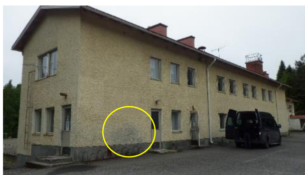
Kuva 5.9.2. Ulkoseinän maalipinnassa paikallisia vaurioita
