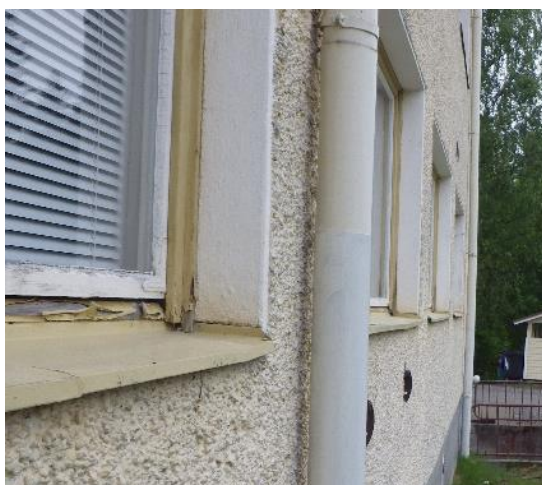
Kuva 5.10.1. Ikkunoiden vesipeltien viettokallistus on vähäinen.
