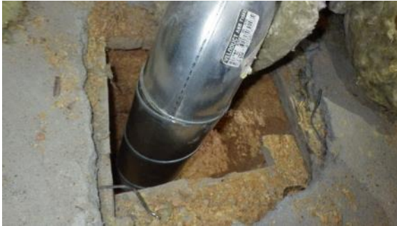
Kuva 5.7.4. Yläpohjarakenteen tutkimuskohta wc-tilan 207 kohdalla olevan IV-kanavan läpiviennin kohdasta. Läpivientä ei ole tiivistetty.
