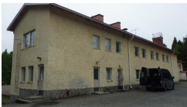
Kuva 5.1.3. Asfalttipihan puolella syöksytorvilta tulevat vedet ohjataan asfaltille ja siitä edelleen viettokalistusten avulla sadevesikaivoihin.
