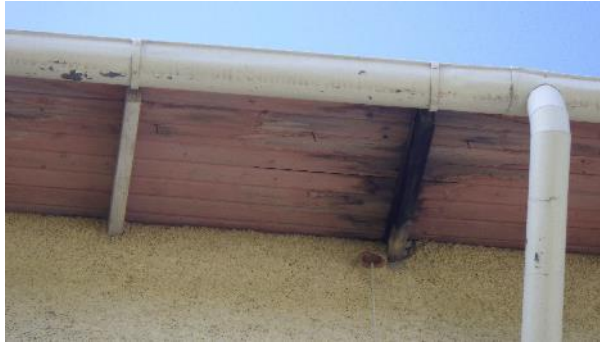
Kuva 5.13.5. Vesikattovuotoa on tapahtunut lumiesteiden kiinnikkeiden kohdasta.
