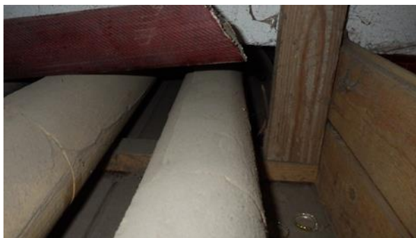
Kuva 5.17.11. Lämpöjohtokoteloissa on pölykerty- mää.
