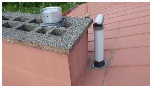
Kuva 5.17.2. Hormeja ei ole sääsuojattu.
