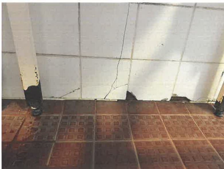
Kuva 2: Pesulan seinälaatat ovat paikoin rikkoontuneet.
