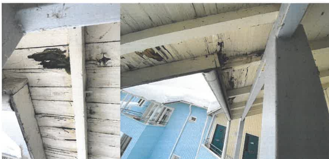
Kuva 10: Jokaisessa talossa on räystäällä näitä lahovaurioita.
