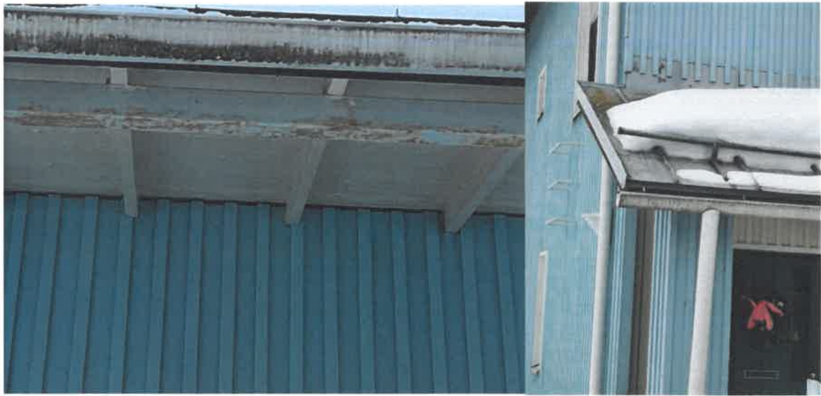
Kuva 11: Vesikatto ja kourut ovat ulkopuolelta likaiset, alla rautapalkin ruosteisuutta.
