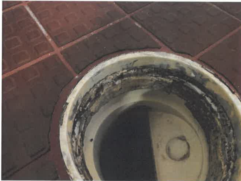
Kuva 15: Korokerengas on hapristunut pois kaivosta.
