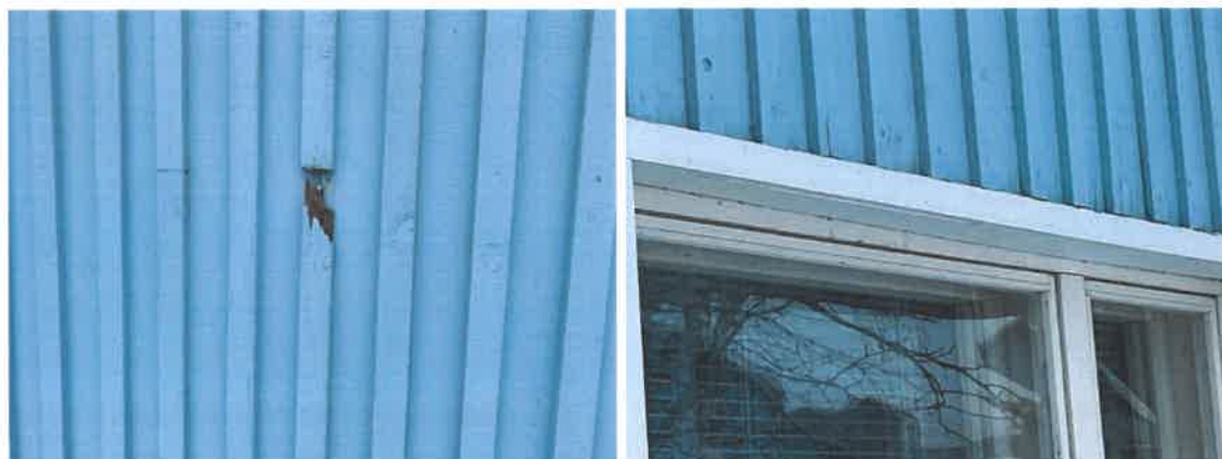
Kuva 5: Esimerkki pystyrimojen saumojen lahovaurioista ikkunan päältä.
