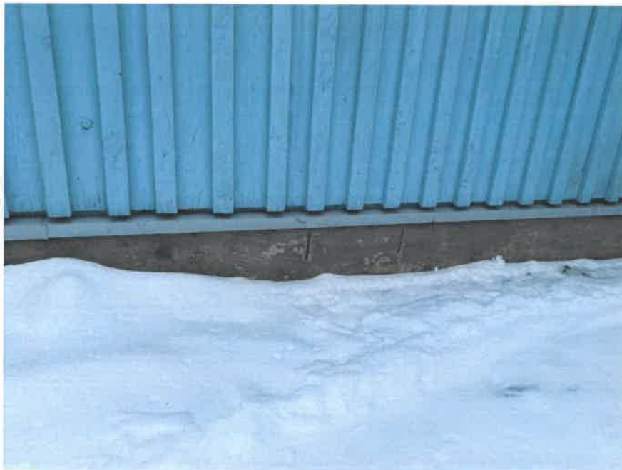
Kuva 4: Pinnoittamaton sokkeli, josta paikoin näkyy teräkset.
