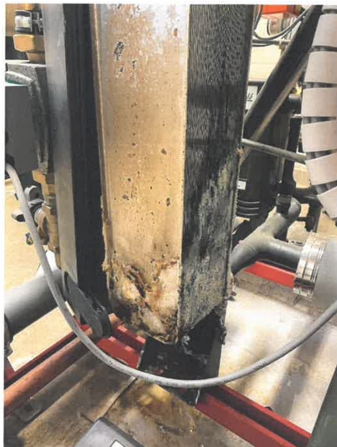
Kuva 14: Lämpimän käyttöveden siirrinpakka vuotaa.
