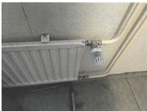
Kuva 12: Patteri ja patteriventtiilit talousrakennuksesta.
