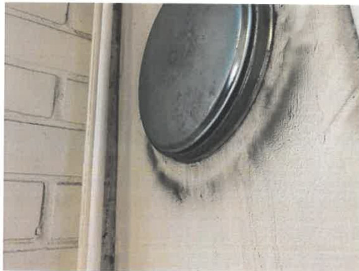
Kuva 16: Kuivaushuoneen venttiili kiinni.
