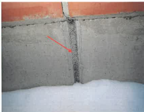
Kuva 4: Kuorielementtien elastisissa saumoissa havaittiin halkeilua.
