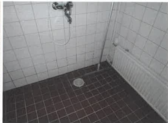
Kuva 20: Pesutilojen pintarakenteiden kunto todettiin heikoksi.
