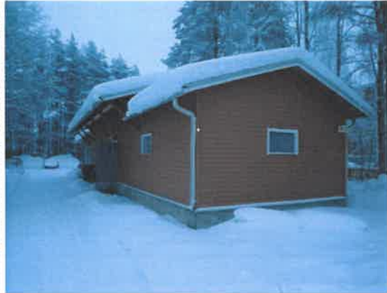
Kuva 6: Lautaverhouksessa havaittiin maalipinnan kulumista.
