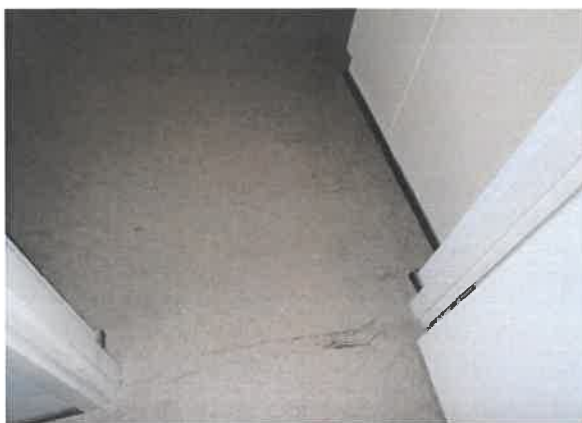
Kuva 22: Asuinhuoneiden muovimattopinnoitteiden tekninen käyttöikä on saavutettu.
