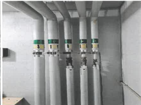
Kuva 32: Kiinteistön lämpö- ja vesijohtoja pohjakerroksessa.
