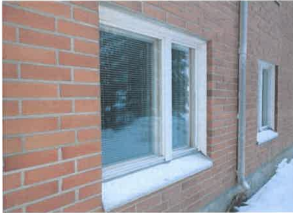
Kuva 7: Ikkunoiden ulkopintojen pintakäsittelyssä havaittiin kulumista ja lievää halkeilua.
