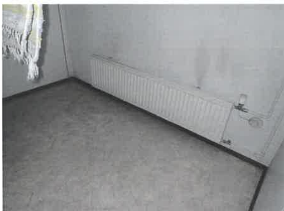
Kuva 29: Radiaattori yleisissä tiloissa.
