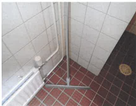
Kuva 30: Termostaatin lähikuva pohjakerroksen saunatiloissa.
