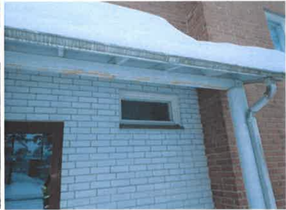
Kuva 14: Vesikouruissa havaittiin pintavaurioita ja likaa.
