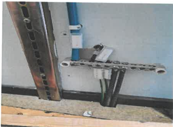
Kuva 47: Päämaadoituskisko pääkeskuksen alla.
