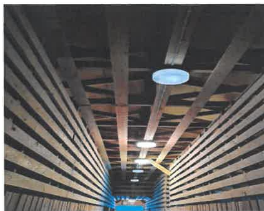
Kuva 54: Varastokomerotilan käytävän valaistusta.
