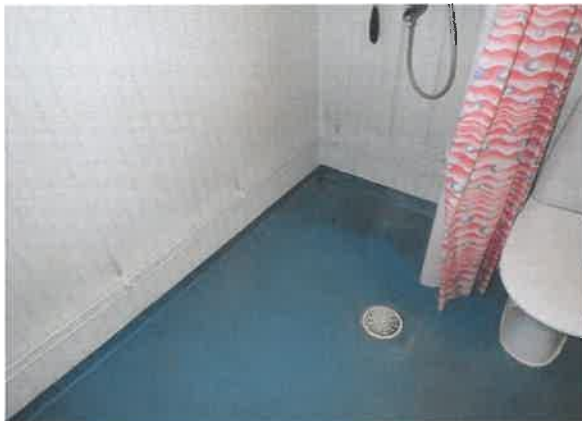
Kuva 24: Kylpyhuoneiden muovipinnoitteiden kunto on heikko.
