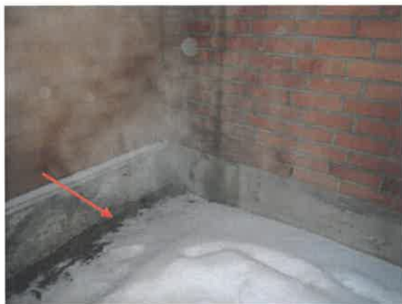
Kuva 3: Perusmuurien ulkopuolisesta vedeneristyksestä ei saatu havaintoja.
