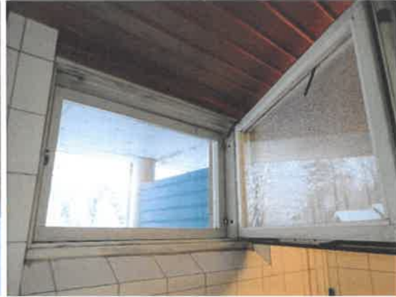
Kuva 8: Ikkunoiden kumitiivisteissä havaittiin kovettumista ja kimmoisuuden häviämistä sekä myös tiivisteiden irtoamista.
