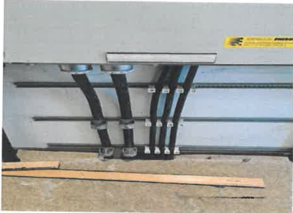
Kuva 45: Pääkeskukselta lähteviä nousujohtoja.
