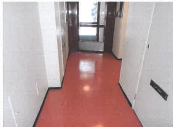
Kuva 18: Vinyylilattalattiapinnoitteiden tekninen käyttöikä on saavutettu.
