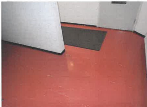
Kuva 17: Vinyylilattalattiapinnoitteiden tekninen käyttöikä on saavutettu.
