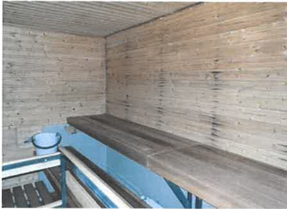
Kuva 19: Löylyhuoneen pintarakenteiden kunto todettiin heikoksi.
