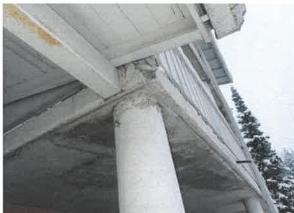
Kuva 11: Parvelattojen alapinnoissa ja pilareiden pinnoissa havaittiin maalipinnan irtoamista ja paikoin myös pinnan rapautumista.
