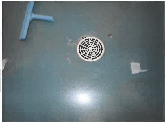
Kuva 25: Muovimattopinnoitteissa havaittiin kulumista ja reikiä.
