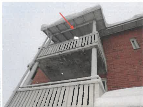
Kuva 12: Ylimmän kerroksen teräspalkkien pinnoissa havaittiin runsaasti ruostumista.
