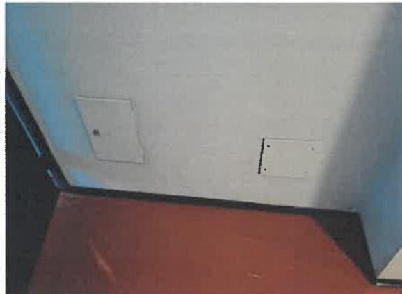
Kuva 59. Antenni- ja puhelinjärjestelmien kytkentärasiat rappukäytävässä.
