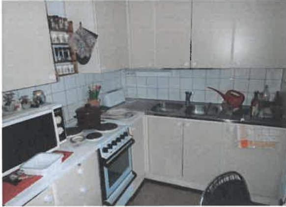
Kuva 26: Keittiökalusteiden kunto havaittiin heikoksi.
