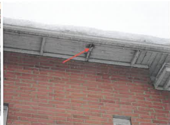
Kuva 16: Raystäiden aluslaudoituksissa havaittiin likaa ja paikoin myös lahovaurioita.
