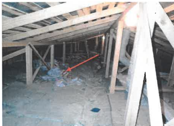
Kuva 15: Yläpohjassa lämmöneristeiden päällä havaittiin varsin runsaasti pakkausmuoveja.
