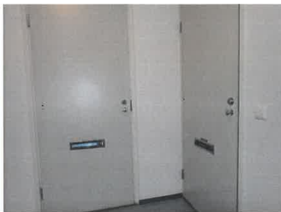
Kuva 23: Asuinhuoneiden väliovien kunto havaittiin heikoksi.
