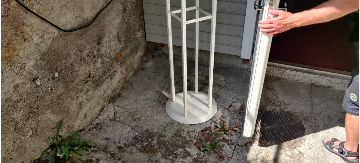
Kuva 4. Kellariin johtava entisen autotallin luiskan alaosaan kertyy kosteusrasitusta. Perusvesikaivo oven kohdalla.
