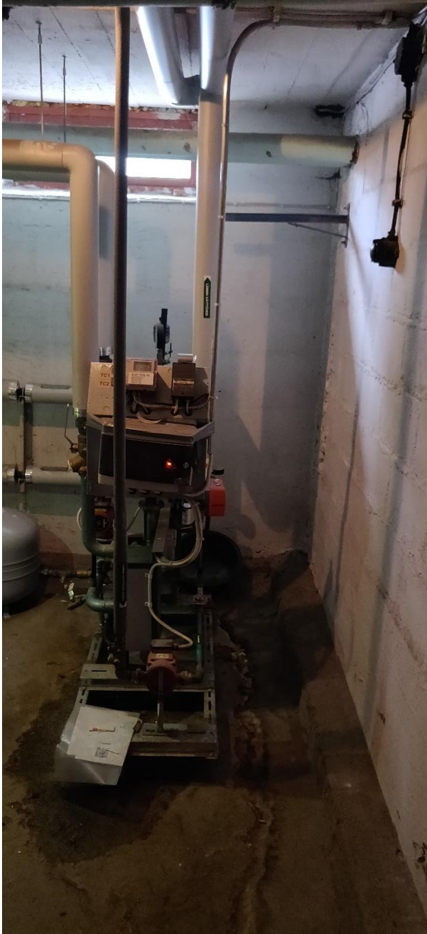
Kuva 6. Lämmitysjärjestelmän tekniikka sijaitsee kellaritiloissa.
