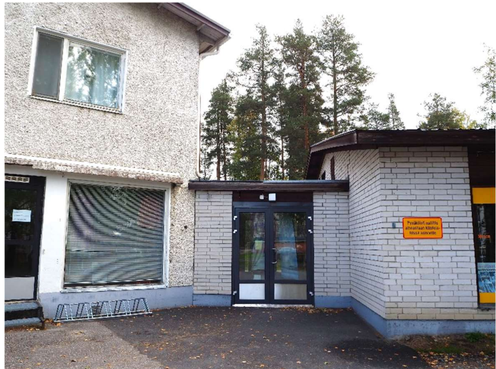
Kuvassa rakennuksia yhdistävä tuulikaappirakenne Tulliportinkadulta päin. Oikealla kuvassa tiilirakenteisena toteutettu laajennusosa, jossa kuvaushetkellä toimii lemmikkieläinliike. Kuva Teija Kokko 2021.
