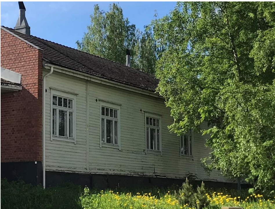
Vanha Rakennusosa Penttilänkadun suunnasta. Seinälaudoitus varsikin alaosastaan lahonnut ja maalipinnat vaurioituneet.
