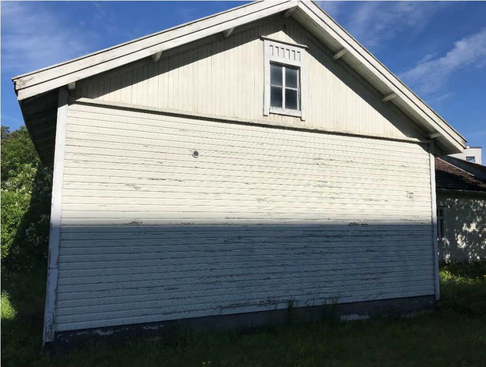
Vanhan rakennusosan pääty. Ulkoseinän maali irronnut.
