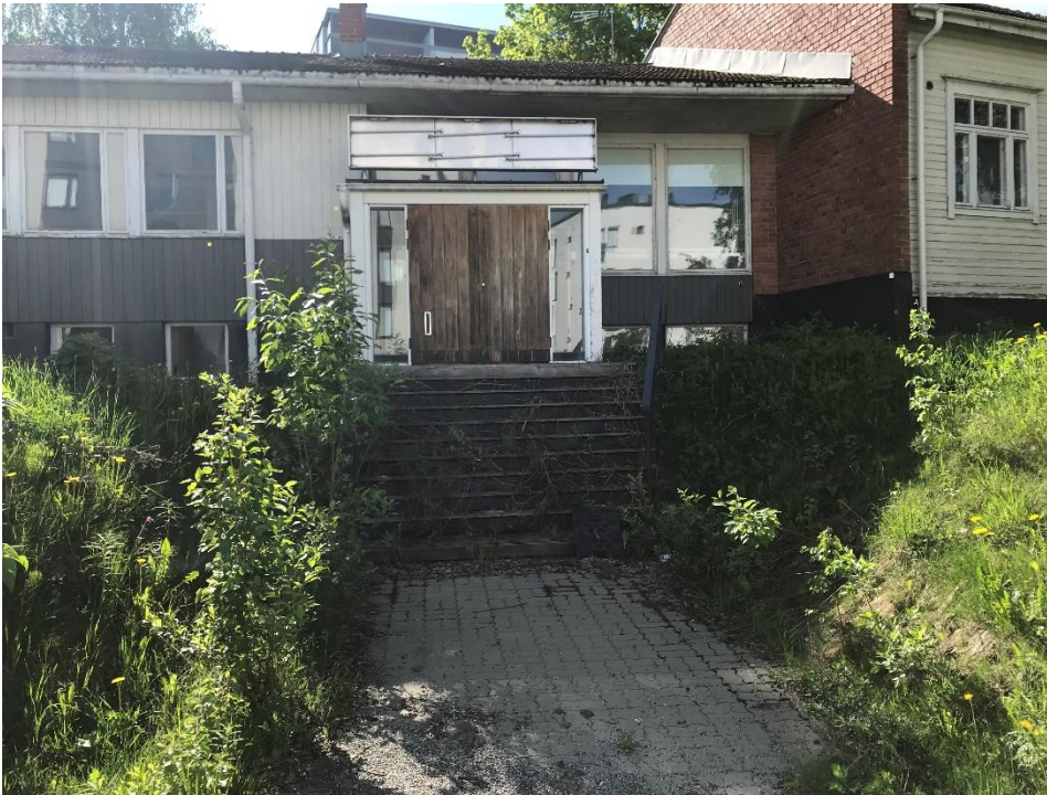
Pääsisäänkäynti Penttilänkadun suunnasta. Laatoituksen vieressä kasvaa paju- tms pensaita. Pääoven yläpuolella olevan valomainoksen etulevy puuttuu. Portaikko kuivan kasvillisuuden peitossa.
