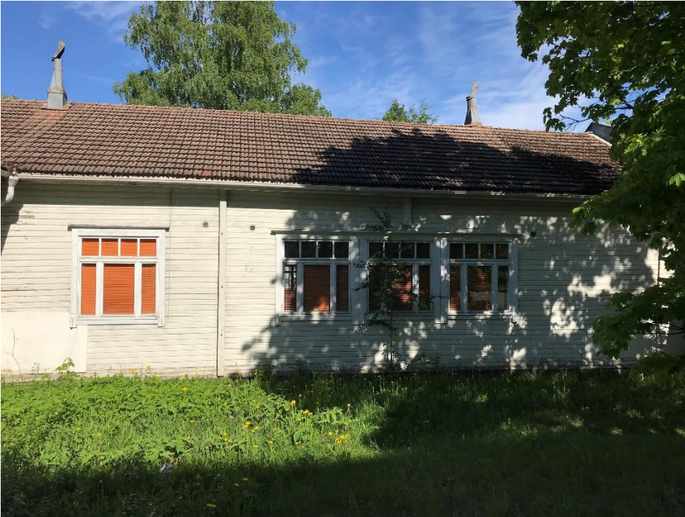
Vanhan rakennusosan Penttilänkadulta poispäin. Seinämaali hilseilee, lautaseinää paikattu levyllä.
