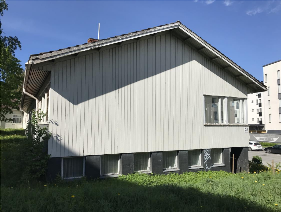
Uuden rakennusosan pohjoispääty. Ikkunapeltien maalaus hilseilee.
