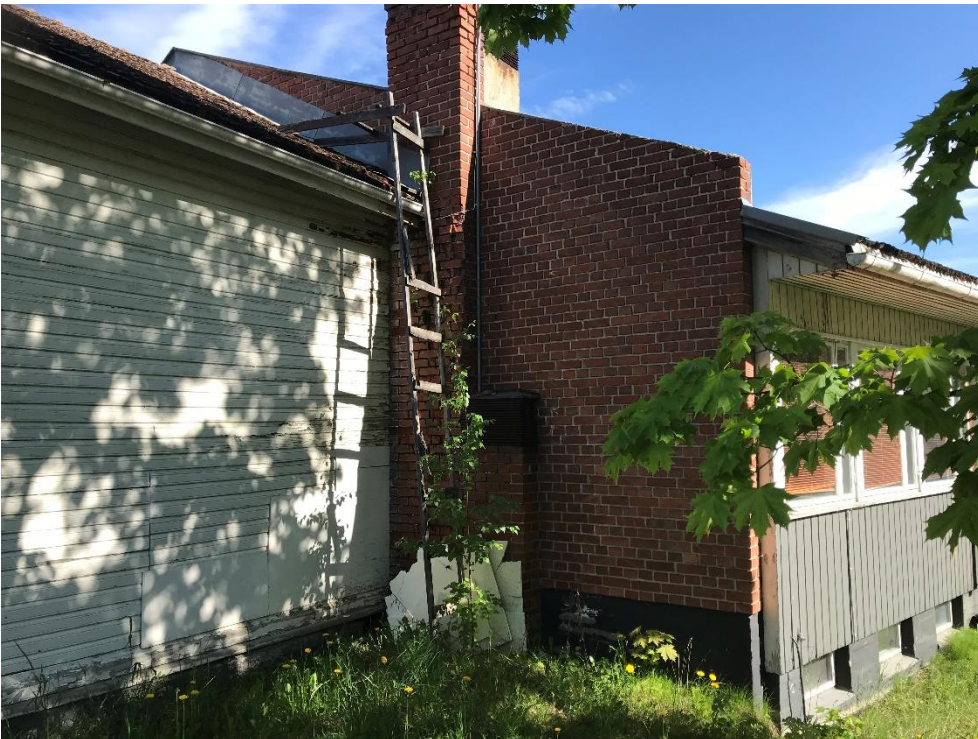
Vanhan ja uuden rakennusosan liittymiskohta. Hormin tiilet rapautuneet ja osin irronneet. Lautaseinää paikattu levyllä. Seinämaali irtoamassa. Katolle johtavat tikkaat lahot ja vaaralliset.
