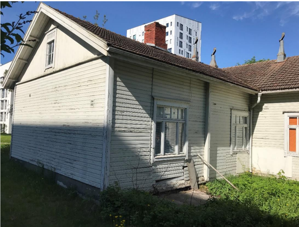
Vanhan rakennusosan pääty. Seinälaudoitus irronnut ja seinämaali hilseilee. Savuhormi rapautunut ja siitä on irronnut tiiliä. Lautaseinää paikkailtu levyillä. Ikkunan alta perustus mahdollisesti vaurioitunut.
