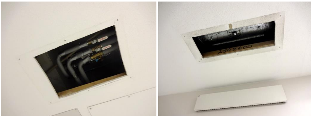
Kuvat: Myös toimistupuolella on jätetty kriittiset talotekniikan paikat helposti löydettäviksi.
