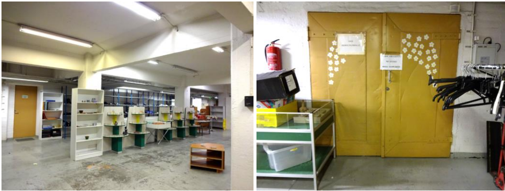
Kuvat: Kellarin varastotilassa matalan siiven alla on toiminut kirpputori ja kierrätyskeskus, jonka jäljiltä tilassa on yhä irtaimistoa. Yksinkertainen ovi johtaa toimisto-osan alla olevaan kattilahuoneeseen ja pariovet varastoon.
