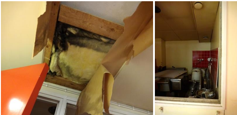
Kuvat: Paikoitellen rakenteiden kunto on heikohko ja hylätyt tilat ovat rojun peitossa.
