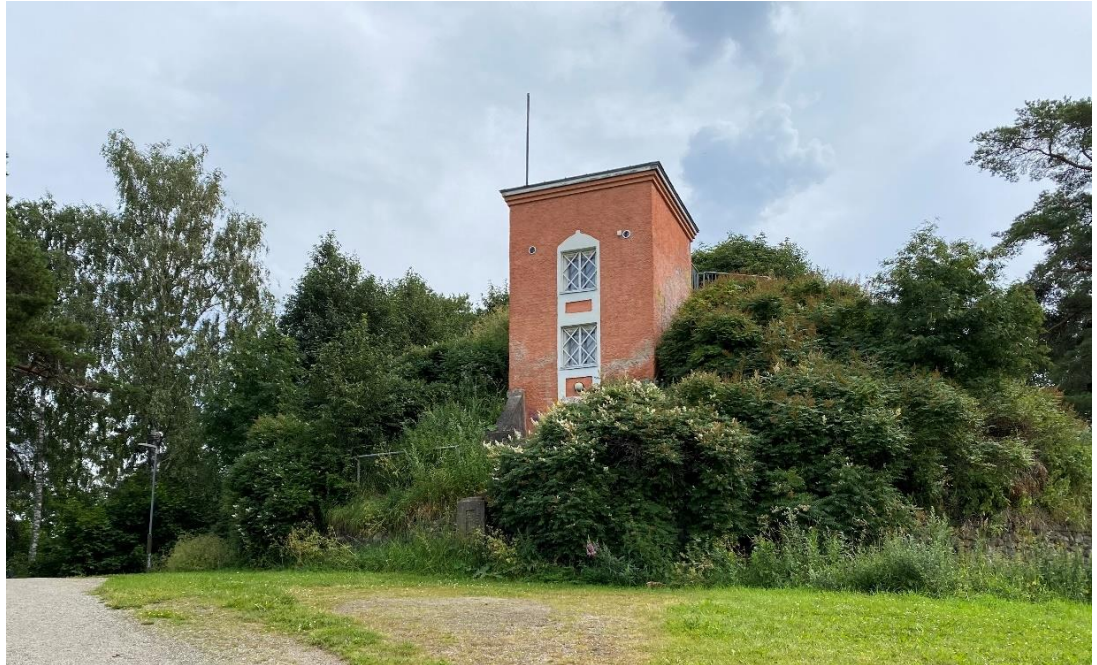
Kuva 5. Niinivaaran vanhan vesisäiliön torniosa on säilyttänyt alkuperäisen asunsa, mutta on ajan myötä ränsistynyt.
