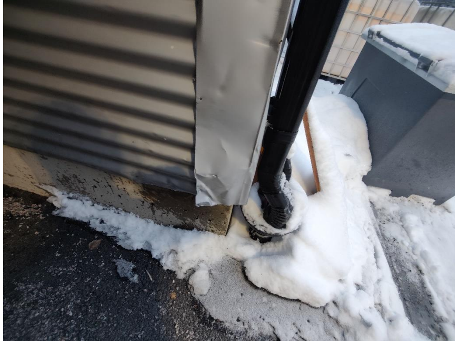
Kuva 19/RAK. Kattovedet on ohjattu syöksytorvin ja rännikaivoin pois rakennuksen vierustalta.
