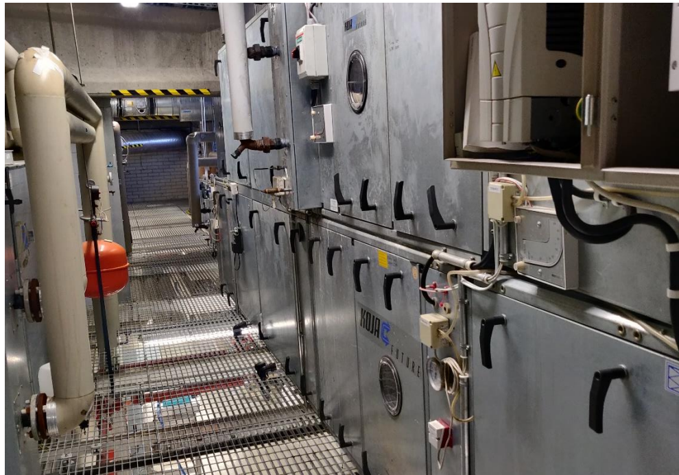
Kuva 16/LVI Ilmanvaihtokoneet ovat kokonaisuudessaan kelvollisessa kunnossa
