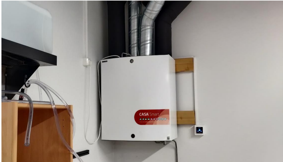
Kuva 3/LVI Lastaus- / lähettämötilaan ja varastotilaan on asennettu uudet ilmanvaihtokoneet
