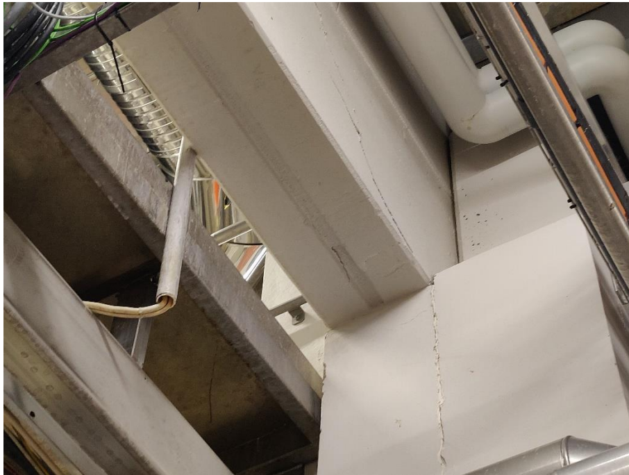
Kuva 26/RAK. Halkeama kantavan betonipilaerin ja väliseinän liitoksessa.
