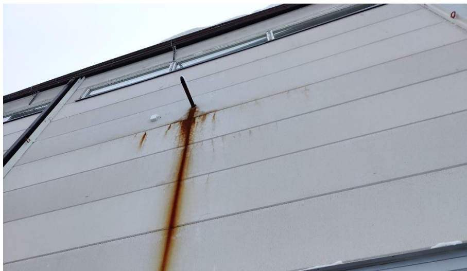
Kuva 31/RAK. Valumajälki ulkoseinän läpiviennin kohdalla.
