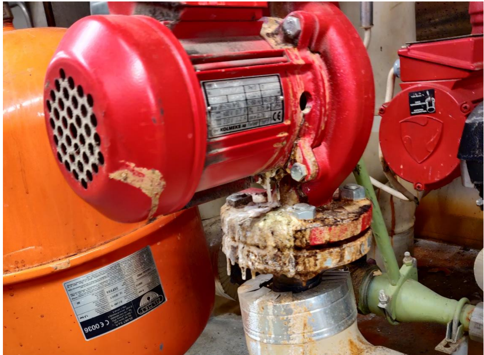
Kuva 9/LVI Kiertovesipumppujen kunto oli pääasiallisesti hyvä, mutta pumppujen laippaliitoksissa havaittiin runsaasti vuotojälkiä
