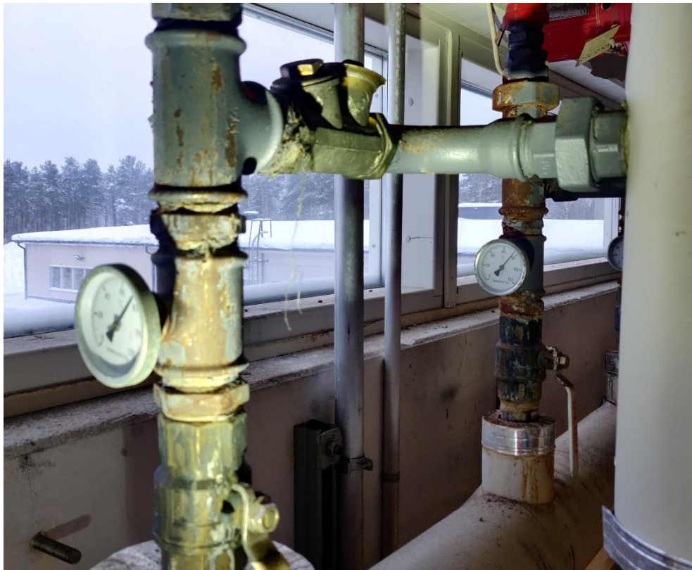
Kuva 10/LVI Lämmitysjärjestelmän sulkuventtiileissä ja mittayhteissä havaittiin vuotojälkiä
