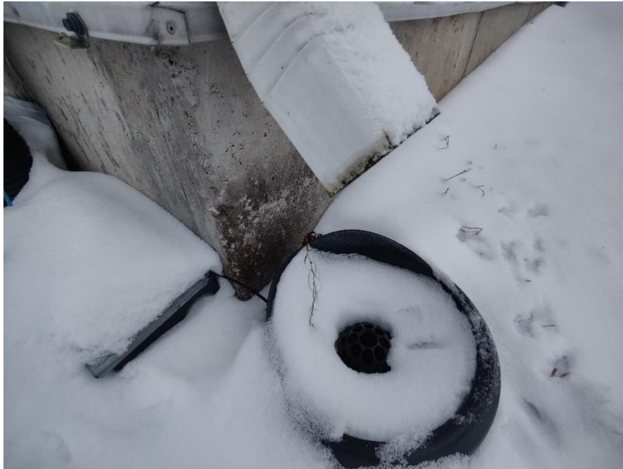
Kuva 1/RAK. Syöksytorvista tulevat sadevedet pääsevät roiskumaan rakennuksen vierustalle.
