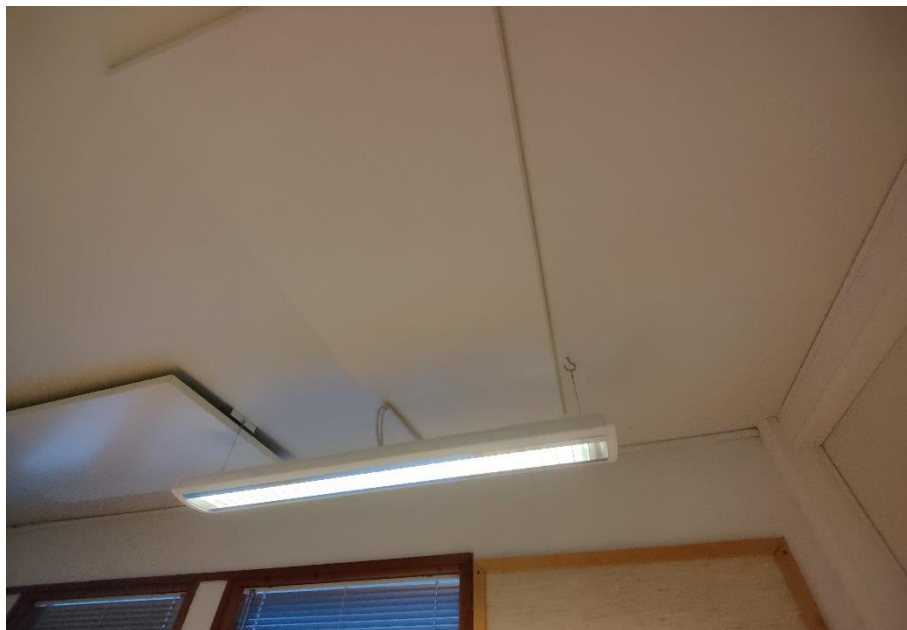
Kuva 15/RAK. Toimisto-osan akustiikkalevy.
