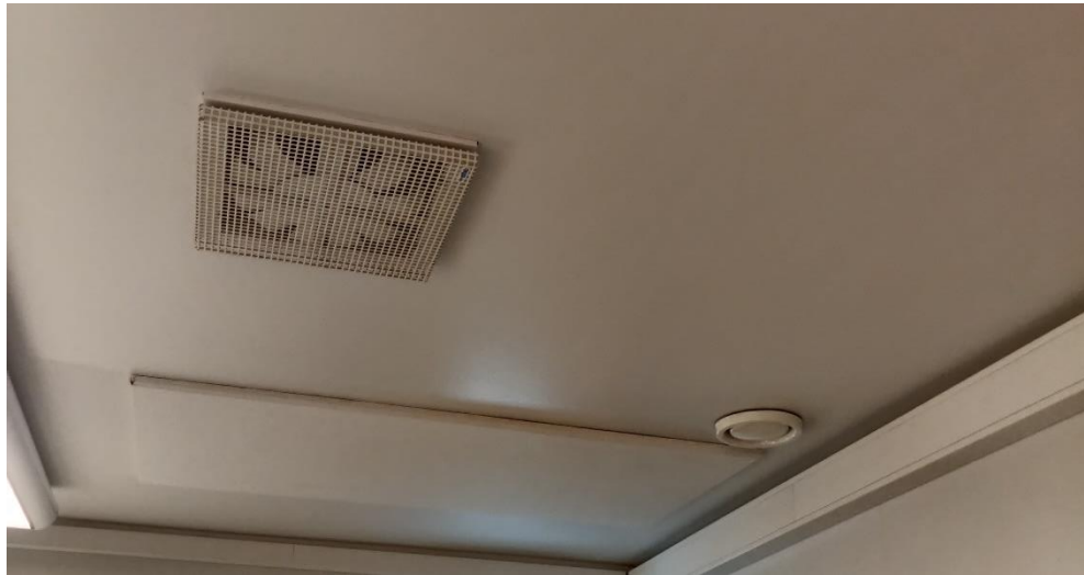
Kuva 5/LVI Toimistotilojen tulo- ja poistoilmanvaihdon päätelaitteet.
