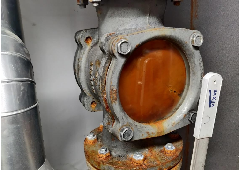
Kuva 26/LVI Jäähdytysjärjestelmän näkölasi
