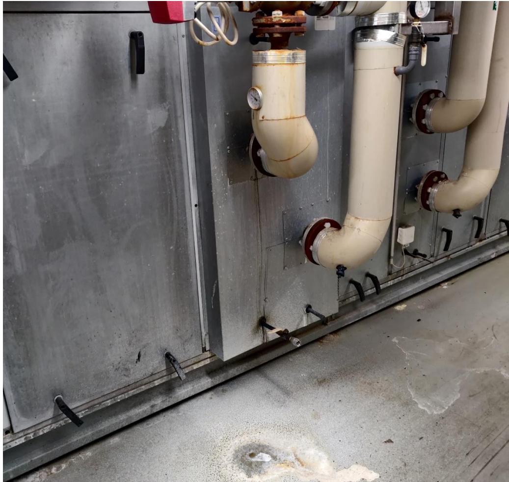
Kuva 17/LVI Ilmanvaihtokoneiden LTO-kytkennöissä havaittiin vanhoja vuotojälkiä
