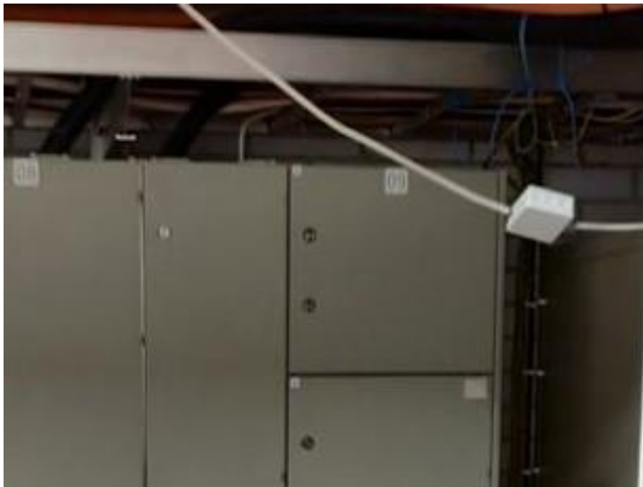
Kuva 3/SÄHKÖ. Roikkuiva ryhmäjohto ryhmäkeskuksessa.
