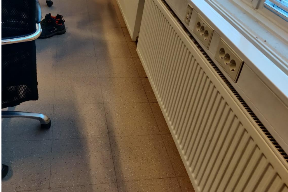
Kuva 11/LVI Toimistotilojen radiaattorit olivat hyvässä kunnossa
