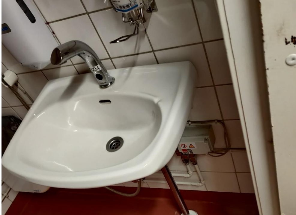
Kuva 15/LVI Rakennukseen on uusittu vesikalusteiksi automaattihanat
