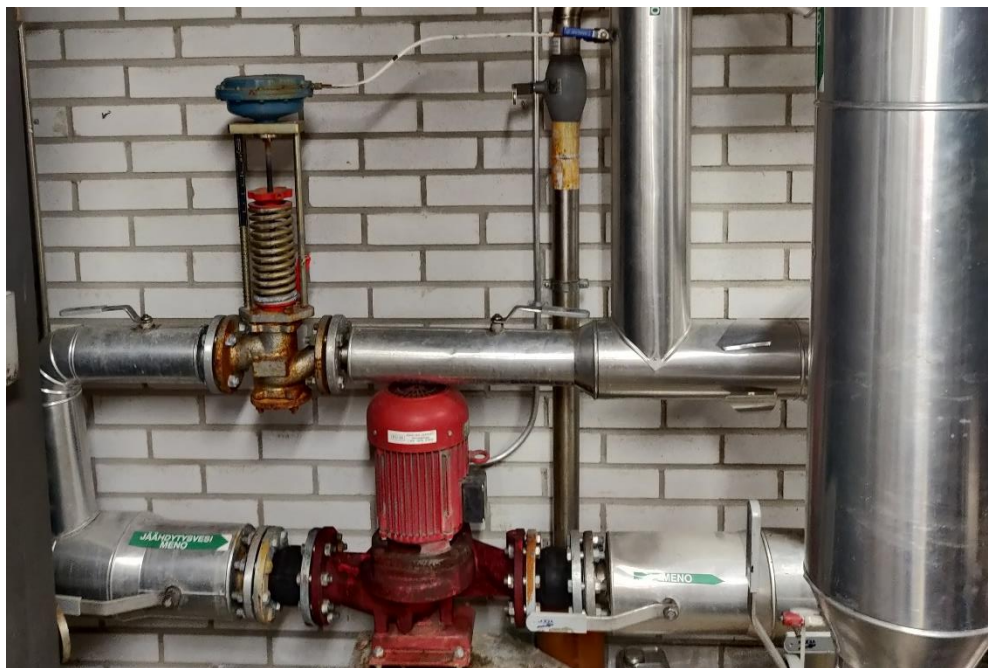
Kuva 27/LVI Kiertovesipumppujen ja venttiilien toiminta tarkastetaan säännöllisesti ja uusitaan tarvittaessa
