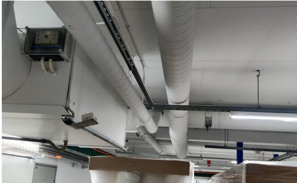
Kuva 1/LVI Toimistorakennuksen toinen alkuperäinen IV-kone sijaitsee varastotilassa
