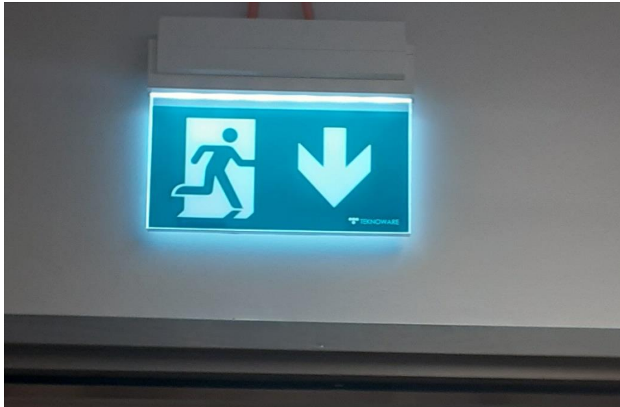
Kuva 7/SÄHKÖ. Hätäpoistumistie valaisin.
