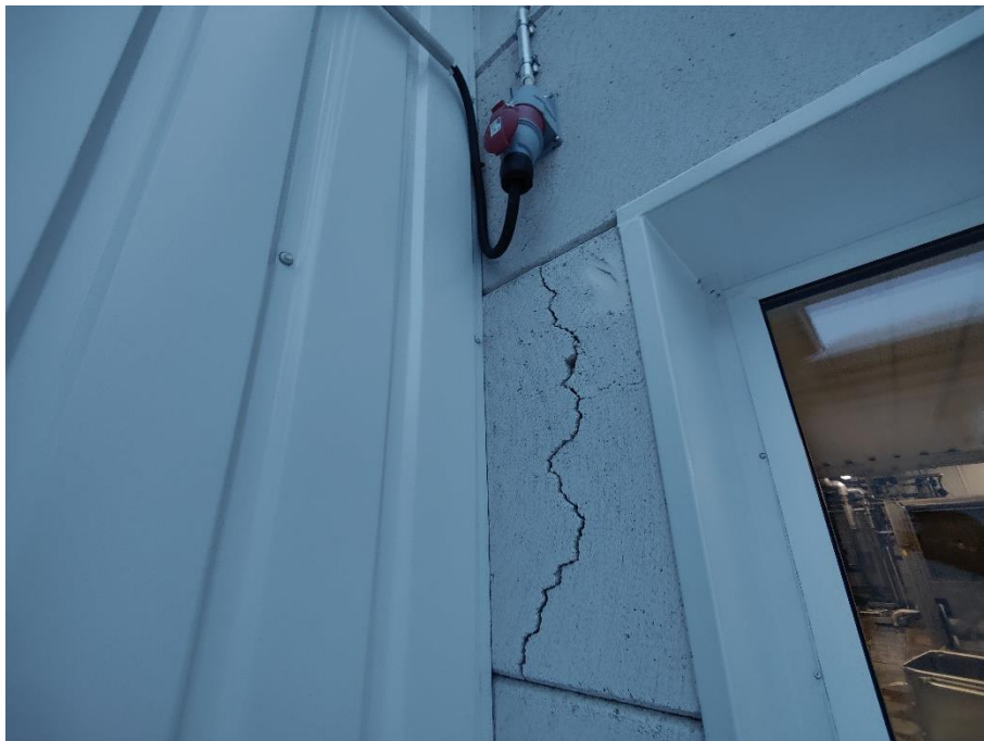
Kuva 23/RAK. Ulkoseinän vauriota rakennuksen ulkopuolelta.
