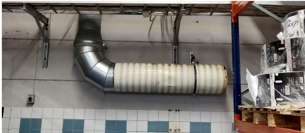
Kuva 21/LVI Osa tuotantotilojen tuloilmapäätelaitteista on ruostunut
