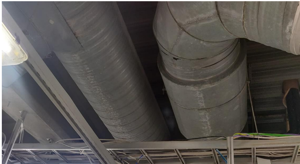
Kuva 18/LVI Tuotantotilojen puolella IV-kanavistossa on jonkin verran hapettumaa
