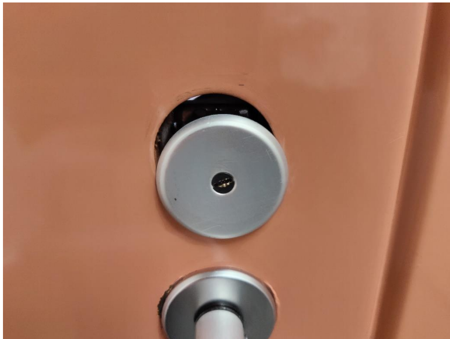
Kuva 39/RAK. Uuden keitto-osaston ja käytävän välisen palo-oven epätiivis peitekilpi.
