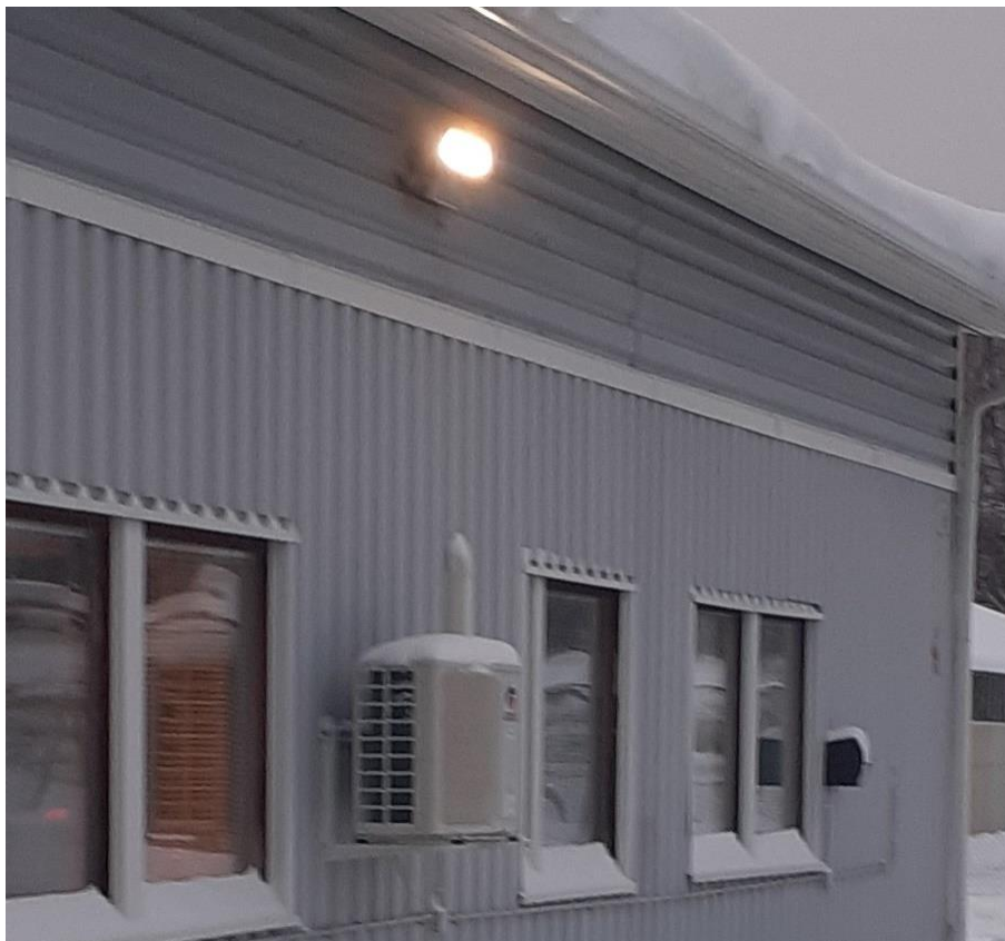
Kuva 1/SÄHKÖ Toimistorakennuksen seinävalaisin.
