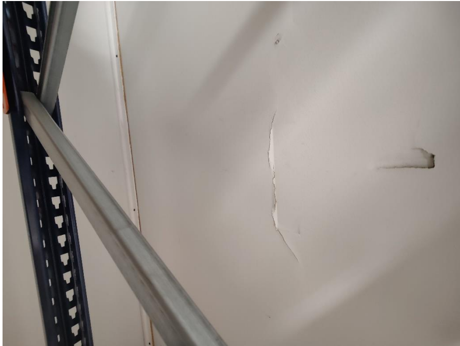
Kuva 9/RAK. Yksittäinen murtuma varastupuolen väliseinässä.
