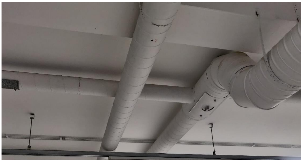
Kuva 4/LVI Toimistorakennuksen kanavisto on hyvässä kunnossa
