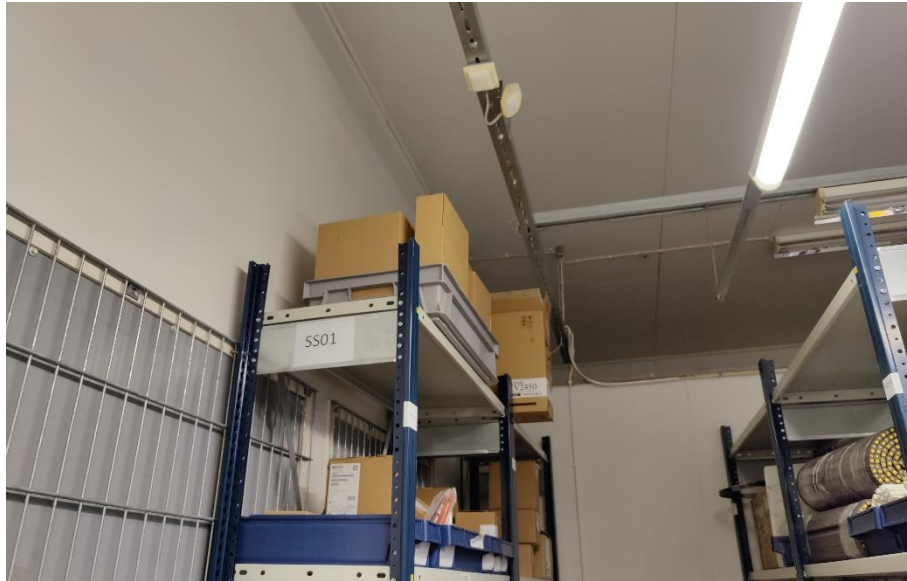
Kuva 16/RAK. Varasto-osan sisäkattopintaa.
