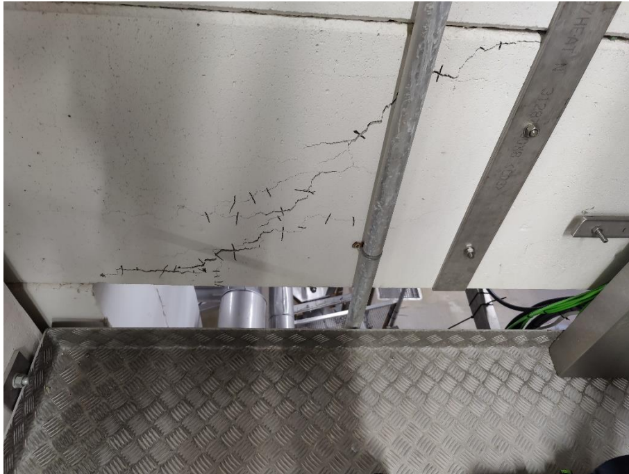
Kuva 27/RAK. Kantavan betonipalkin halkeama.
