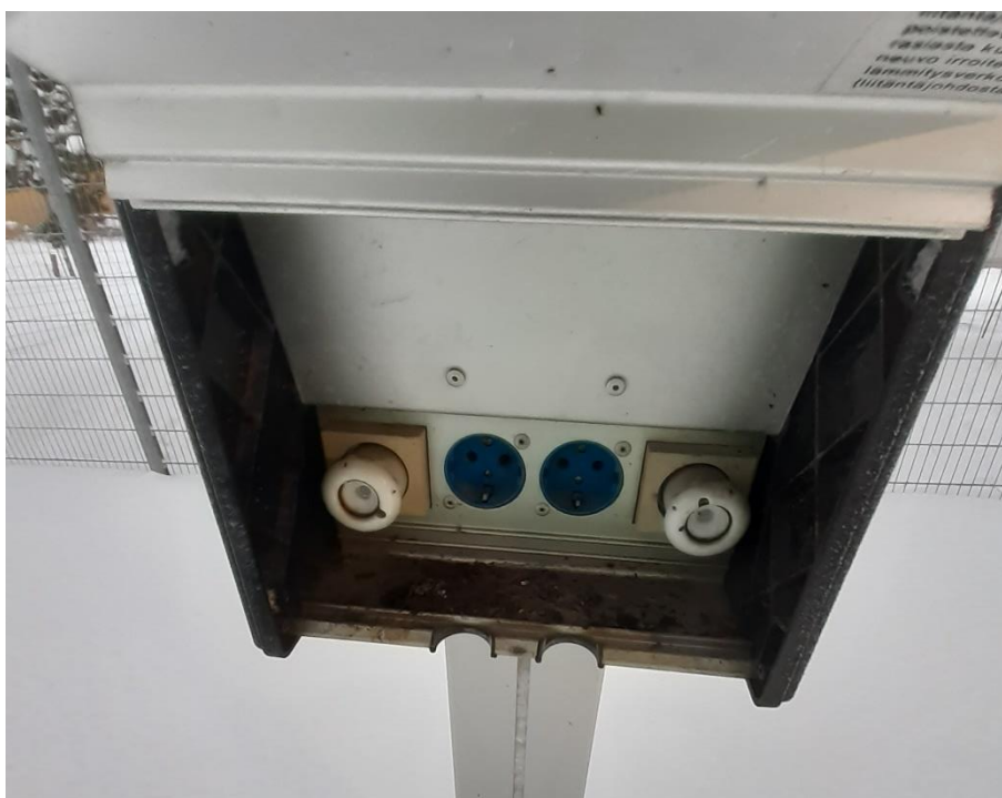
Kuva 2/SÄHKÖ. Alkuperäinen autolämmityskotelo.
