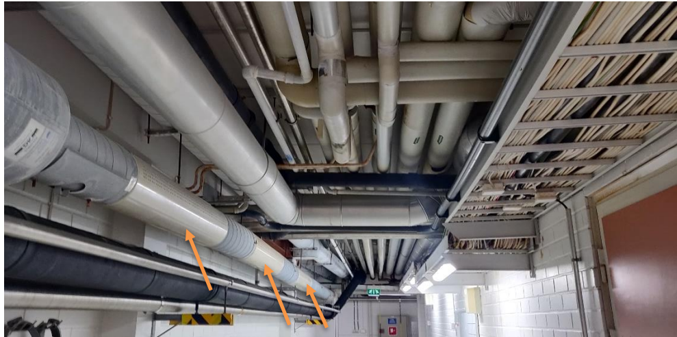
Kuva 22/LVI Käytävän tuloilmanjako ei ole toteutettu optimaalisesti
