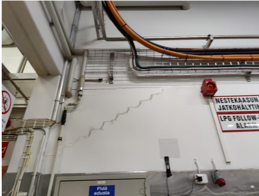
Kuva 24/RAK. Kantavan väliseinän muurauksen halkeamaa on paikattu massamalla.
