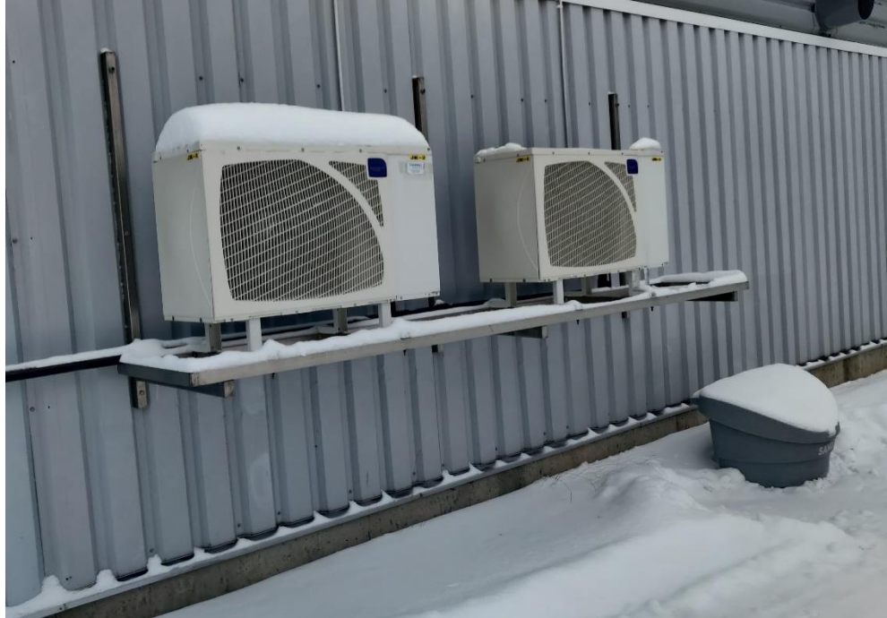
Kuva 6/LVI Jäähdytysjärjestelmän ulkoyksiköt
