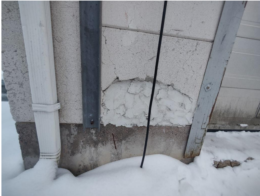
Kuva 22/RAK. Ulkoseinän vauriota ulkopuolelta.
