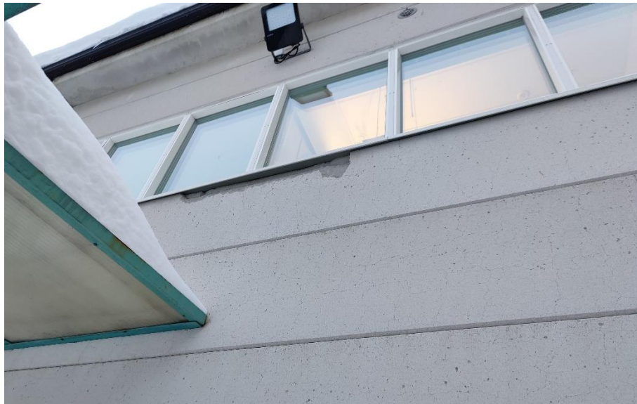
Kuva 30/RAK. Ulkoseinän rapautunut tasoite.
