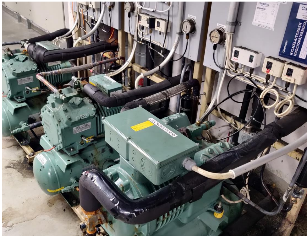
Kuva 24/LVI Pakkasia ja kylmiöitä palvelevien kompressorien uusimiseen tulee varautua
