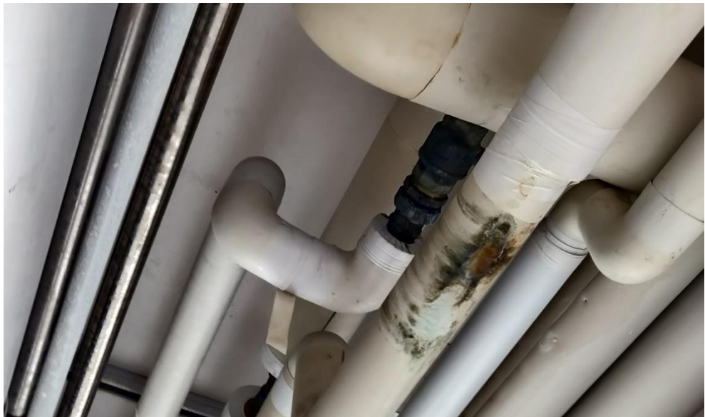
Kuva 14/LVI Käyttövesijohtojen vuotojälkiä
