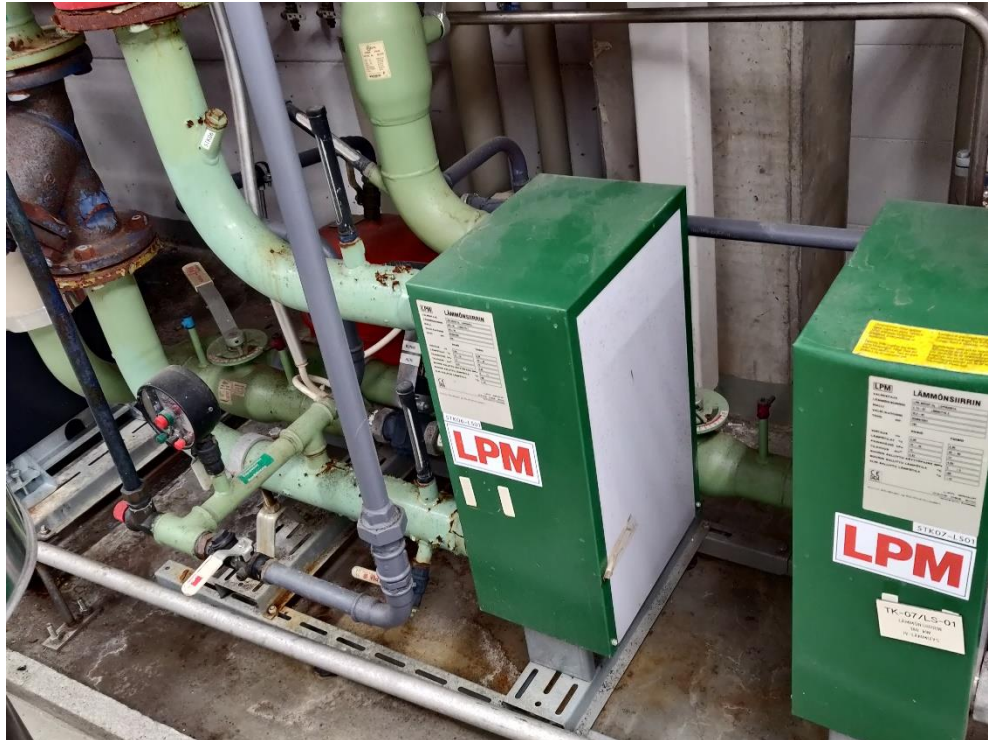
Kuva 7/LVI Alkuperäisten lämmönvaihtimien uusimiseen tulee varautua. Kuvassa tuloilmakoneita palvelevat lämmönvaihtimet.
