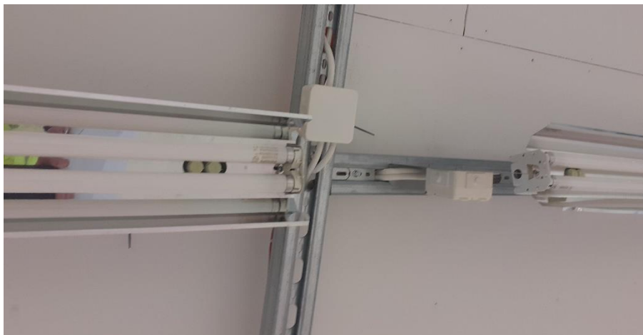
Kuva 5/SÄHKÖ. Rikkinäinen loistevalaisin.
