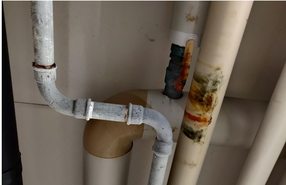
Kuva 13/LVI Käyttövesijohdoissa ja venttiileissä havaittiin useita vuotojälkiä
