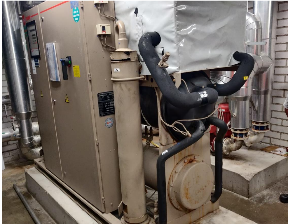
Kuva 25/LVI Kompressorihuoneen nestejäähdyttimen uusimiseen tulee varautua
