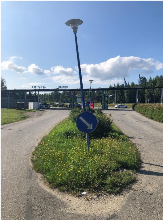
Kuva 10 Valopylväs ja liikennemerkki vinossa, valopylvään maalipinta kulunut
