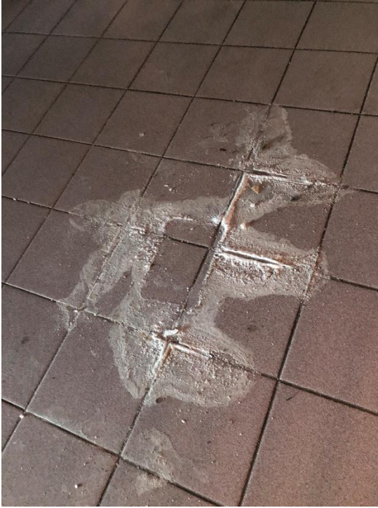
Kuva 44 Vesivahingon alueella runsaasti kalkkihärmää
