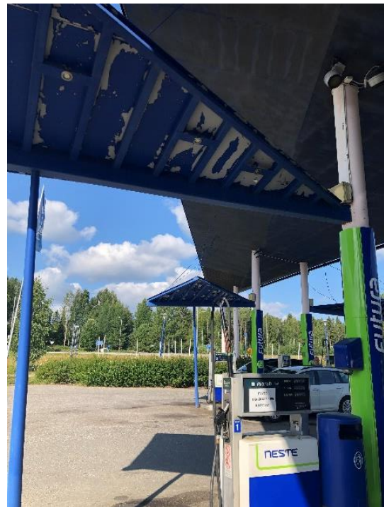
Kuva 15 Polttoaineaseman lippojen maali-pinta kulunut
