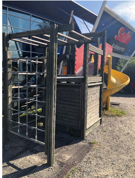
Kuva 11 Verkko on kulunut, suositellaan uusia
