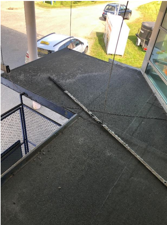
Kuva 28 Tankkauskatoksen alla olevan sisäänkäyntikatoksen vesikate uusimatta
