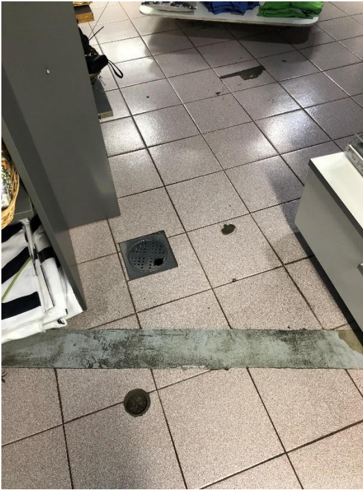
Kuva 40 Vanha väliseinän kohta pinnoittamatta, vanhoja kiinnitys jälkiä ja halkeilua
