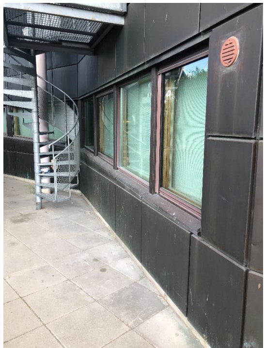
Kuva 23 Julkisivun pinta huonossa kunnossa
