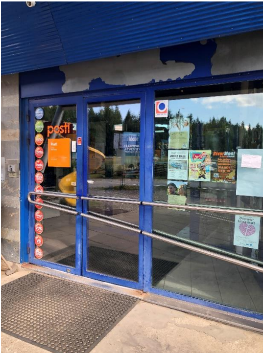
Kuva 26 Pääoven maalipinta huono
