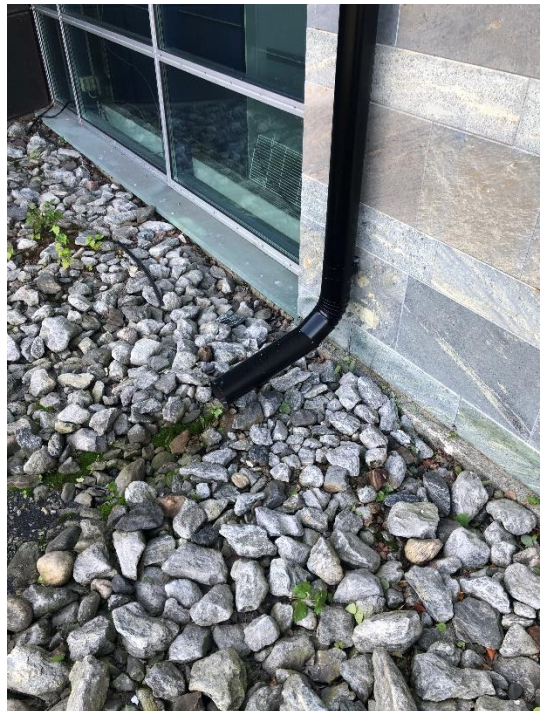
Kuva 35 Osasta syöksitorvista vedenpoisto puuttuu kokonaan
