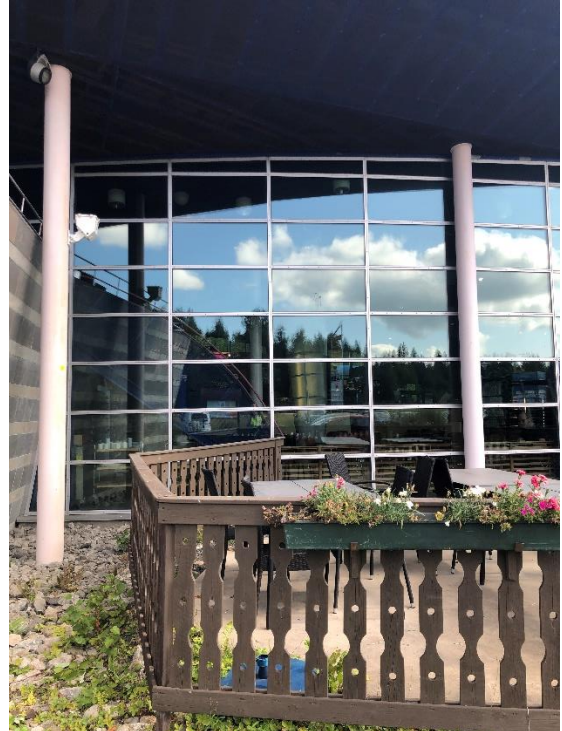
Kuva 17 Etupihan lasiseinä kunnossa
