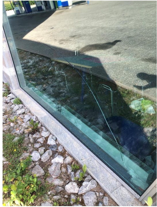
Kuva 25 Kabinetin ikkuna rikki
