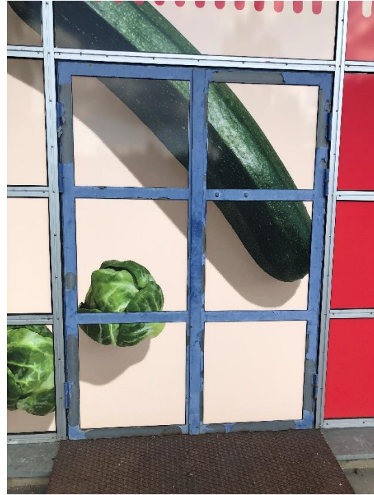
Kuva 27 Vanhan oven maalipinta huono
