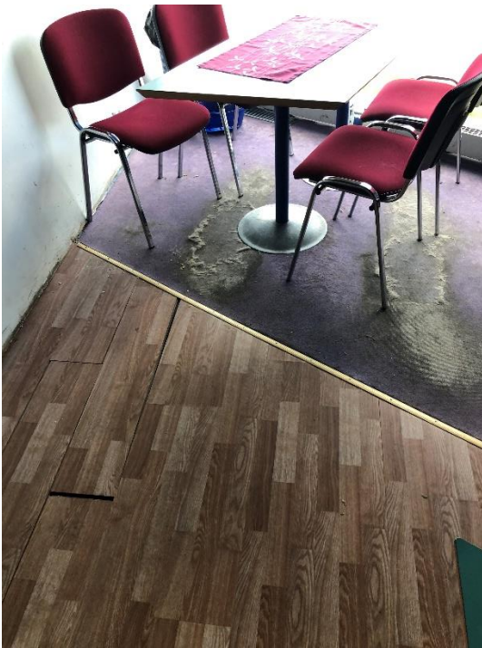
Kuva 42 Kabinetin lattia huonossa kunnossa
