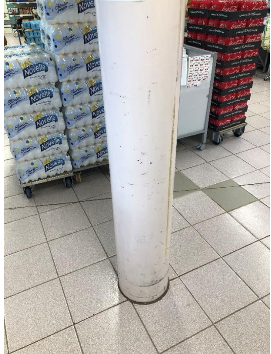
Kuva 45 Pilareiden maalipinta huonokuntoinen
