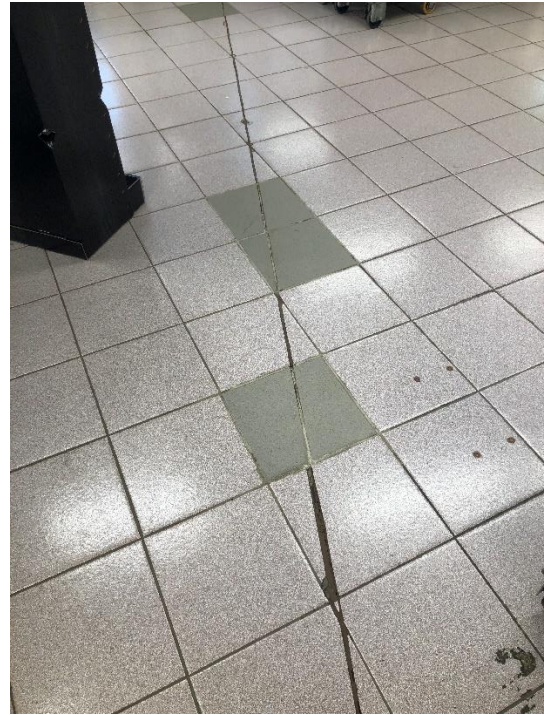
Kuva 41 Liikuntasauva huonossa kunnossa, vanhoja kiinnitys jälkiä, laattoja vaihdettu.
