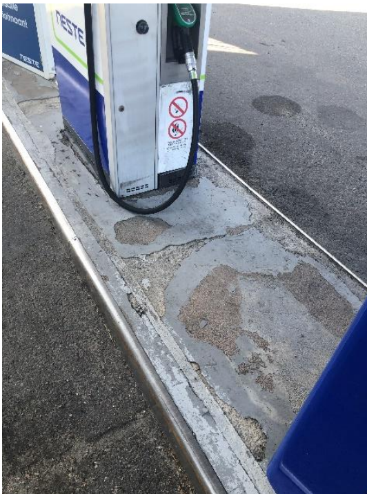
Kuva 14 Polttoaineaseman koroke huonossa kunnossa
