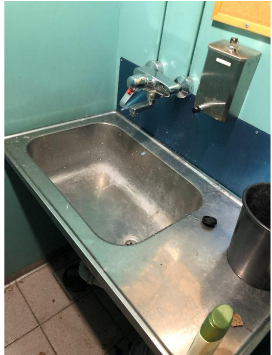
Kuva 51 Vesikalusteet huonossa kunnossa
