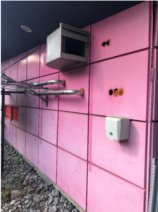
Kuva 18 Maalipinta huonossa kunnossa, läpiviennit tiivistämättä
