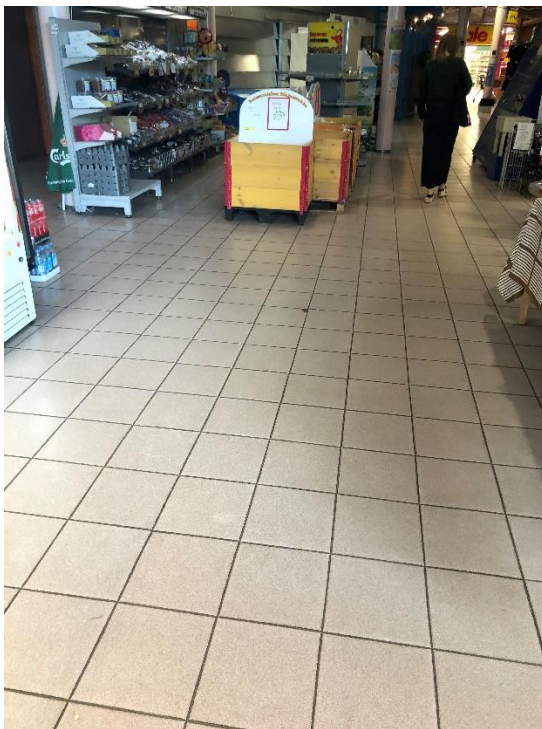
Kuva 38 Yleiskuvaa lattiasta, halkeilua ja vanhoja kiinnitysjälkiä
