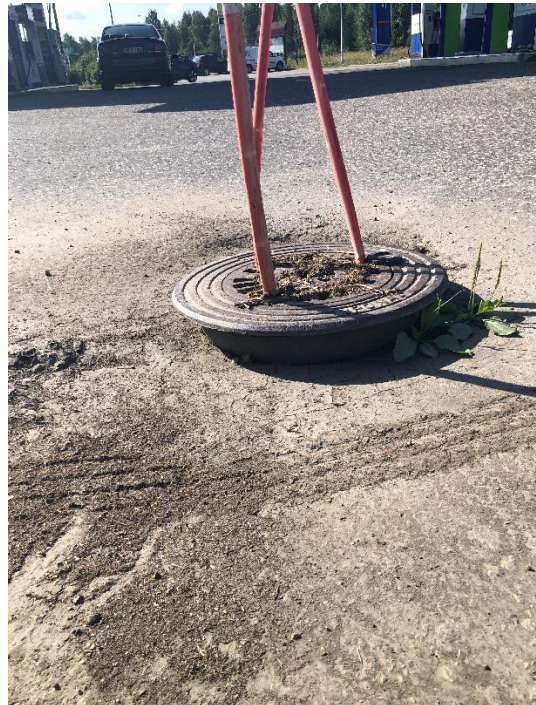
Kuva 4 Kaivo koholla keskellä liikennealuetta
