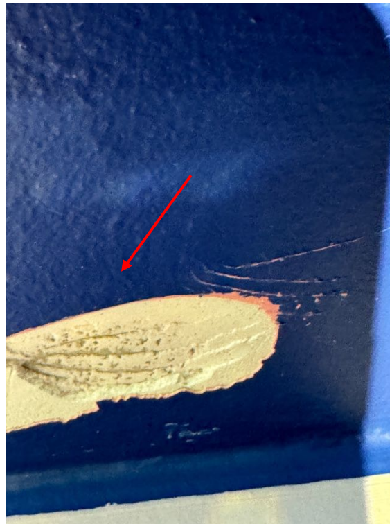
Kuva 6 Kabinetin katon maalit sisältävät vaarallisen jätteen raja-arvon ylittävän määrän raskasmetalleja (sinkkiä näytteessä 13).
