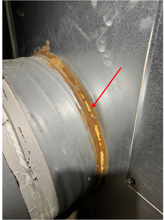
Kuva 4 IV-kanaviston tiivistemassat sisältävät vaarallisen jätteen raja-arvon ylittävän määrän raskasmetalleja (sinkkiä).
