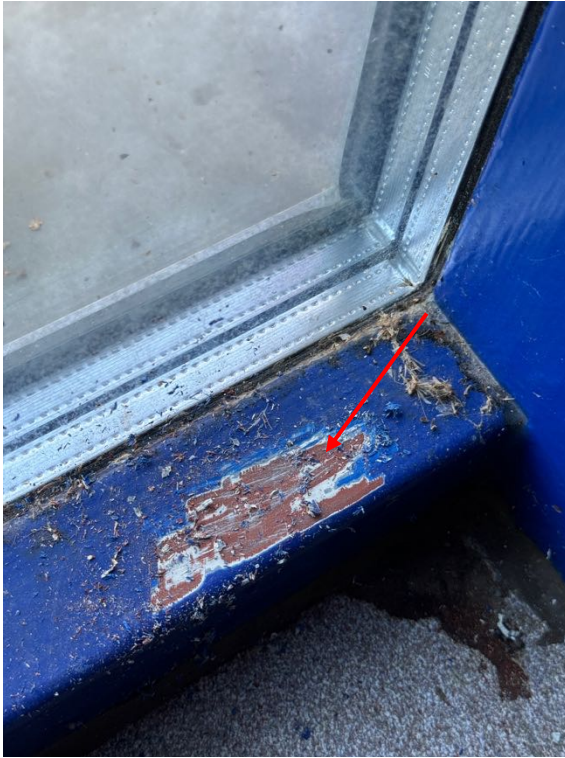
Kuva 3 Ikkunoiden maalit sisältävät vaarallisen jätteen raja-arvon ylittävän määrän raskasmetalleja (lyijyä ja sinkkiä).
