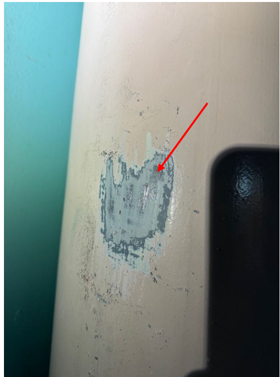
Kuva 2 Teräspilarien maalit sisältävät vaarallisen jätteen raja-arvon ylittävän määrän raskasmetalleja (sinkkiä).
