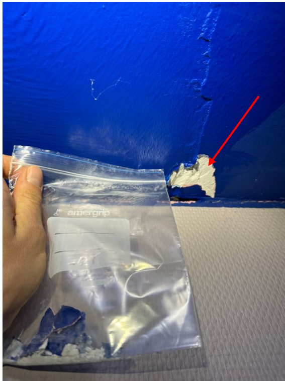
Kuva 1 Kabinetin katon maalit sisältävät vaarallisen jätteen raja-arvon ylittävän määrän raskasmetalleja (kuparia näytteessä 1).
