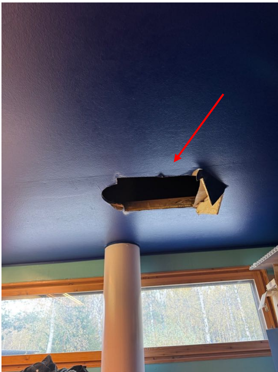
Kuva 5 Kattojen siniset maalit sisältävät vaarallisen jätteen raja-arvon ylittävän määrän raskasmetalleja (kuparia).
