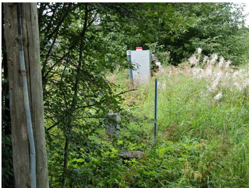
Kuva 16 Jäteveden pumppaamo rannan lähellä
