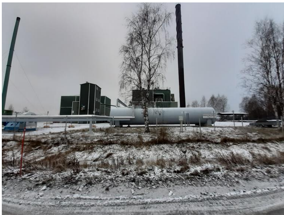
Kuva 8. Nevel Oy:n kaukolämpöä tuottava varavoimalaitos.
