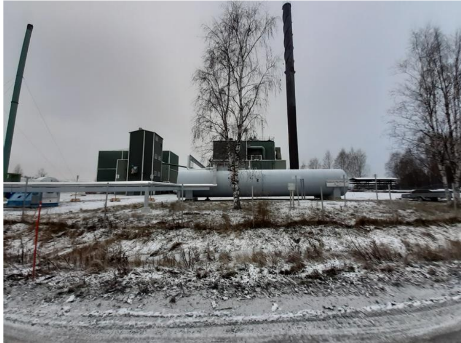
Kuva 8. Nevel Oy:n kaukolämpöä tuottava varavoimalaitos.
