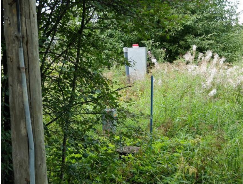
Kuva 16 Jäteveden pumppaamo rannan lähellä
