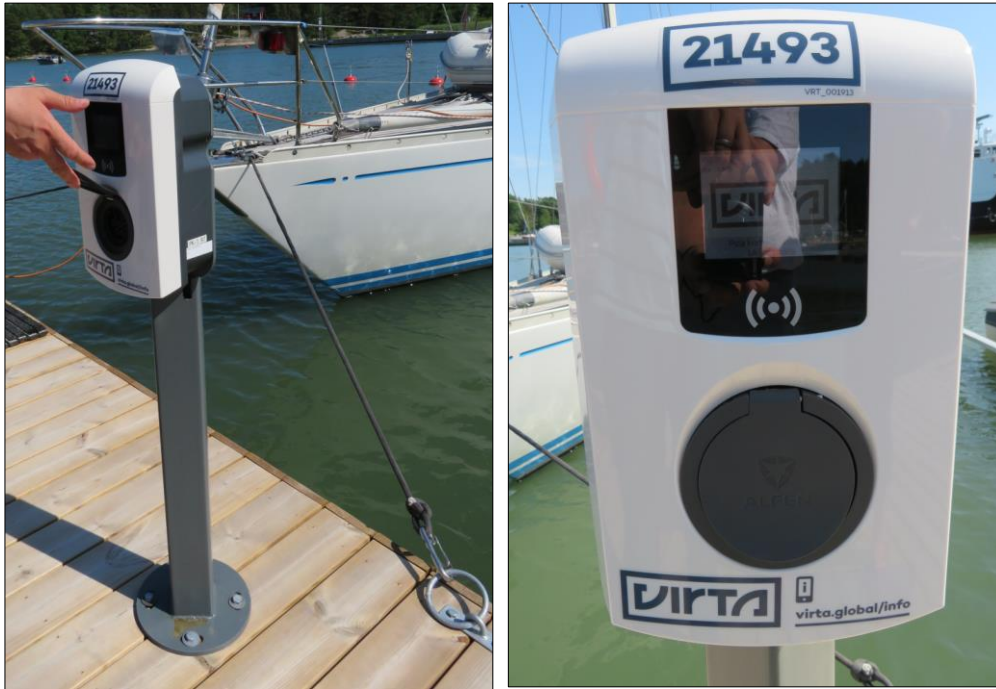
Kuva 38. Parainen, Nauvon vierassatama; sähköveneiden latauspiste (Kuva FCG).
