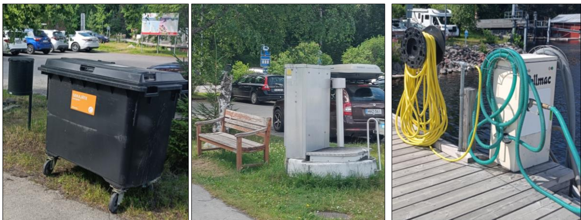
Kuva 16. Roska- ja jäteastia, vesipiste ja septitankin tyhjennyslaite sekä jätevesipumppaamo (FCG 2024).
