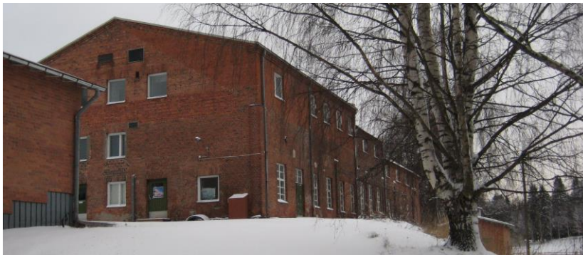
Kuva 4. Suojeltu Osuusmeijerin rakennus nykytilassaan. (Lähde: Liperin rakennettua kulttuuriympäristöä 2015 – FCG Arkkitehdit, FCG Suunnittelu ja tekniikka Oy)
