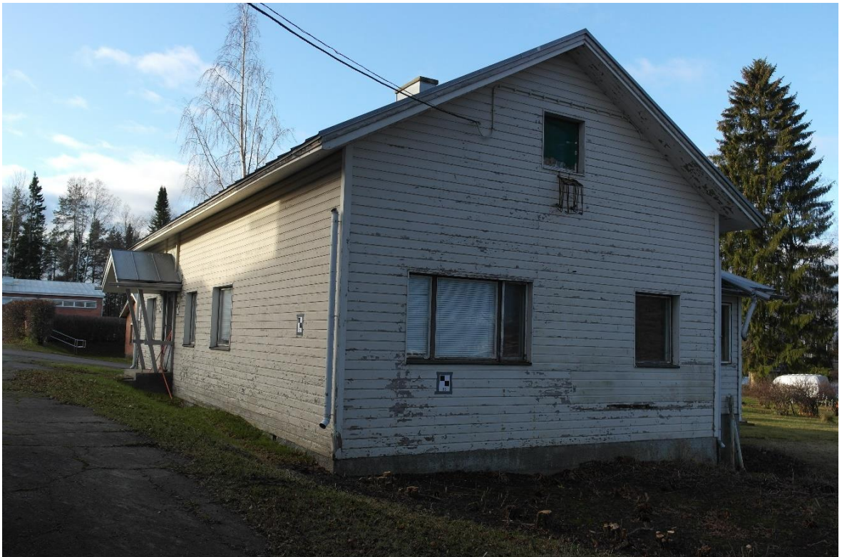
Kuva: Rakennus kuvattuna kesällä 2021 meijerirakennuksen puoleiselta sivustalta. Meijerin puoleiselta sivustalta sadevedet valuvat esteettä perustuksiin ja ulkoseinään. Aavakax Oy:n arkisto.
