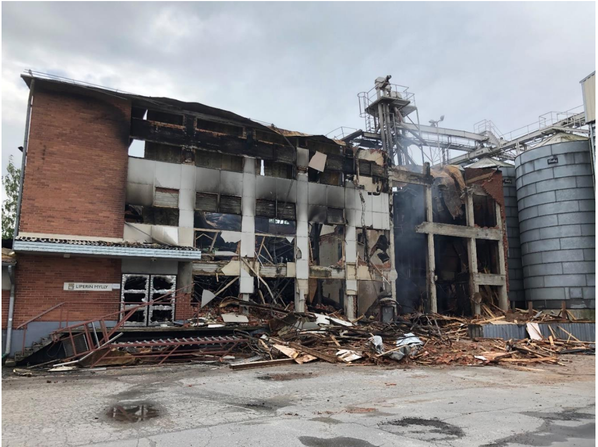
Kuva: Myllyrakennus etupihalta kuvattuna. Puiset välipohjarakenteet tuhoutuneet täysin ja julkisivu/ulkoseinärakenne säilynyt vain osittain kantavien betonirakenteiden osalta. Lähde: Aava-kax Oy:n arkisto.
