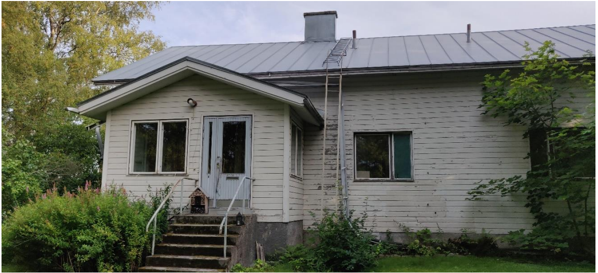
Kuva: Rakennus kuvattuna kesällä 2021 rannan puoleiselta sivustalta. Julkisivun lahovauriot ovat nähtävissä useissa kohdin rakennusta puupintojen ja lautojen hajoamisena. Aavakax Oy:n arkisto.
