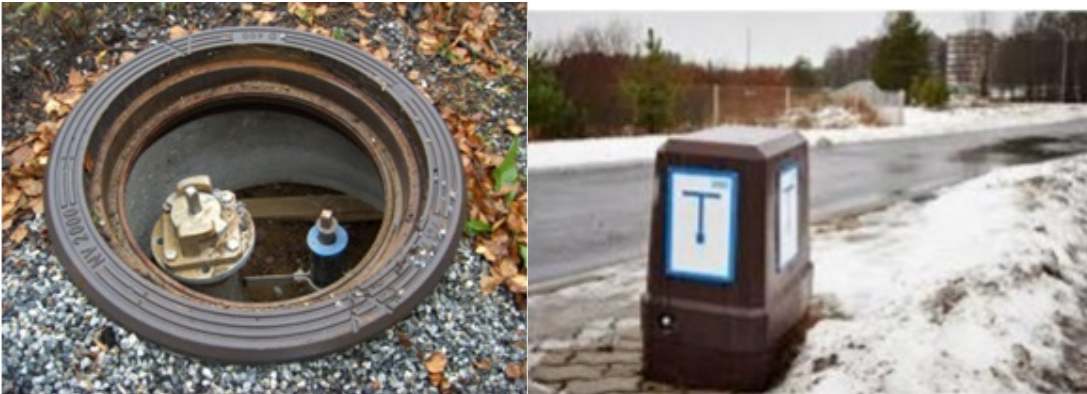
Kuva 1 & 2: Maanalainen palopostirakenne ja maanpäällinen vesiasema.
