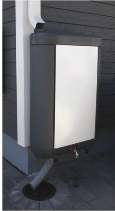
Kuva 7. Kattovesien kerääminen säiliöön (Kuva: Rakentaja.fi).
