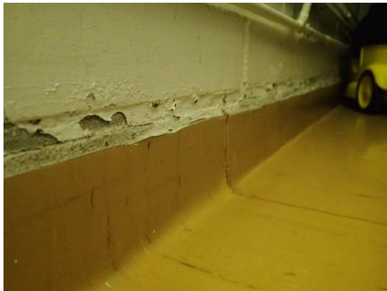
Kuva 11. G-osa, tila SV 109. Väliseinän alaosassa olevia kosteusjälkiä.
