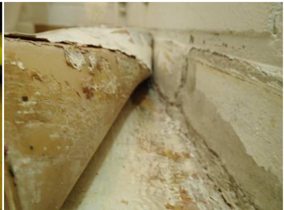
Kuva 12. G-osa, tila WC 108. Väliseinän läheisyydessä alustasta irronnut muovimatto.
