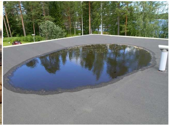
Kuva 16. F-osa, vesikatteella olevaa lammikoitunutta vettä.
