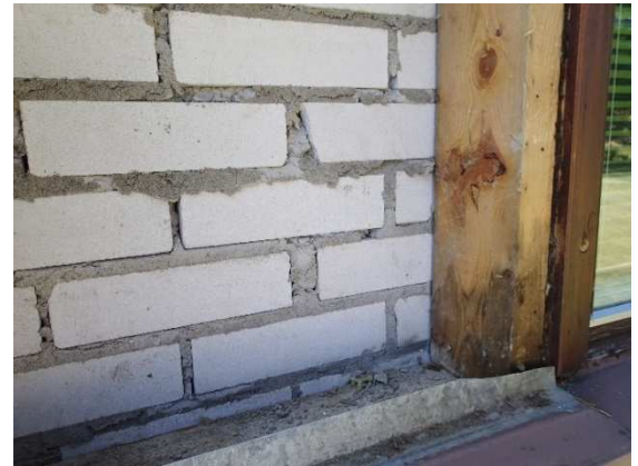
Kuva 10. Ulkoseinärakenne paneeliverhouksen takana huoneen 106 kohdalla. Karmipuissa tuoreita kosteusjälkiä.
