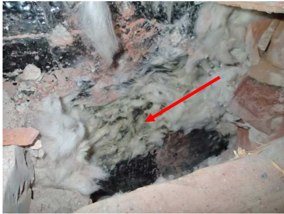
Kuva 2. C-osa, Varasto 4, perusmuurin bitumisivelyn pintaan kiinni liimautunut eriste.
