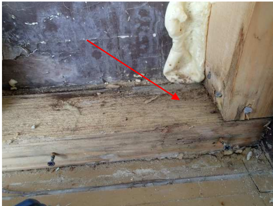
Kuva 13. Ulkoseinärakenteen alaosa lahovaurioitunut.
