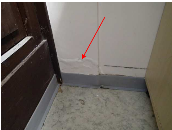
Kuva 4. D-osa, tilan kanslia 120 ulko-oven vieressä vaurioitunut kipsilevy
