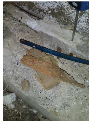
Kuva 6. Tilan 200 sokkelirakenteessa havaittiin vähäinen määrä puuta.
