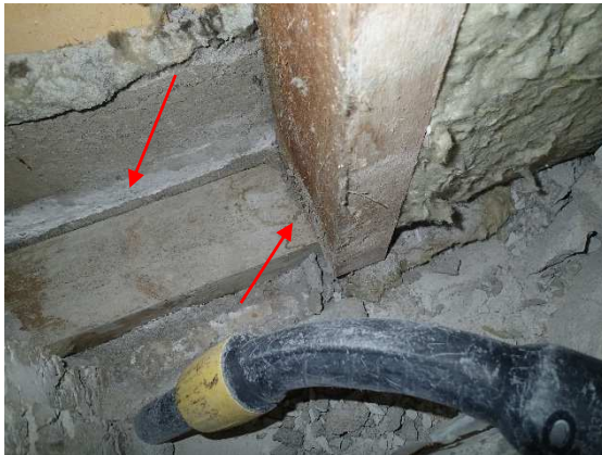
Kuva 9. Sokkelin sisäpinnassa kalkkihärmettä. Alaohjauspuussa kosteusjälkiä.
