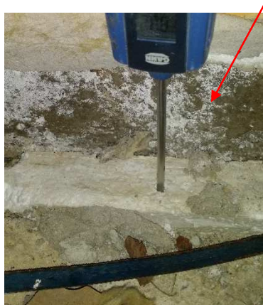
Kuva 7. Sokkelirakenteen sisäpinnalla havaittiin kalkkihärmettä.
