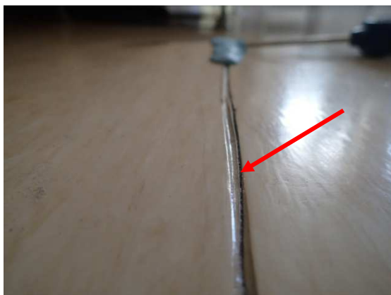
Kuva 1. A- ja B-osa, välinehuolto 012, alapohjan muovimaton epätiiveyskohtia.
