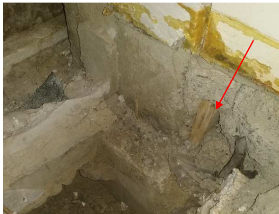
Kuva 5. Tilan 207 väliseinärakenteen alaosaan havaittiin puuta.
