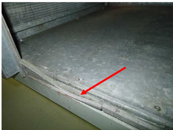
Kuva 23. A-osa, puhallinkammio. Tiivisteiden ohivuotoja.
