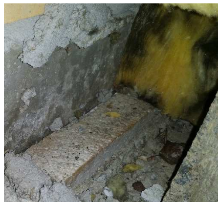
Kuva 8. Tilan 200 sokkelirakenteessa havaittiin vähäinen määrä puuta.
