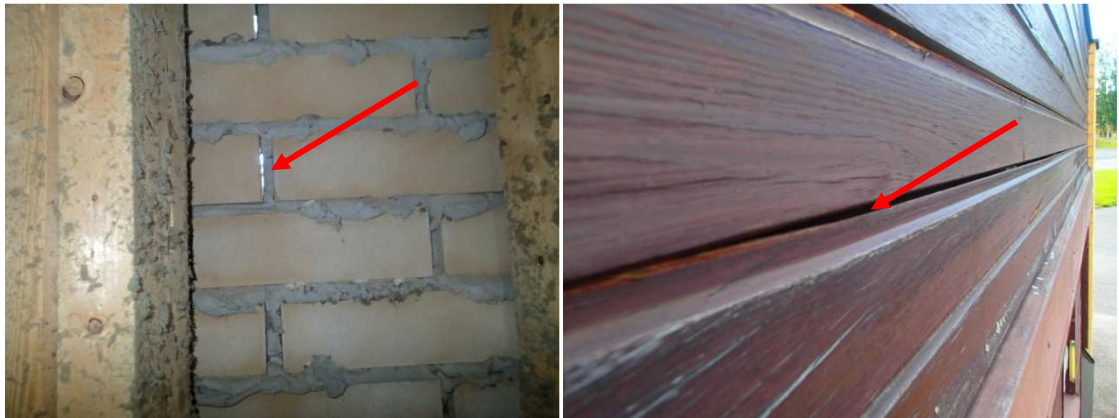
Kuva 21. E-osa, korkean osan tiiliverhouksen epätiiveyskohtia.
