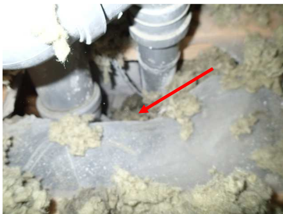
Kuva 19. F-osa, yläpohjan epätiivit lämpiviennit.
