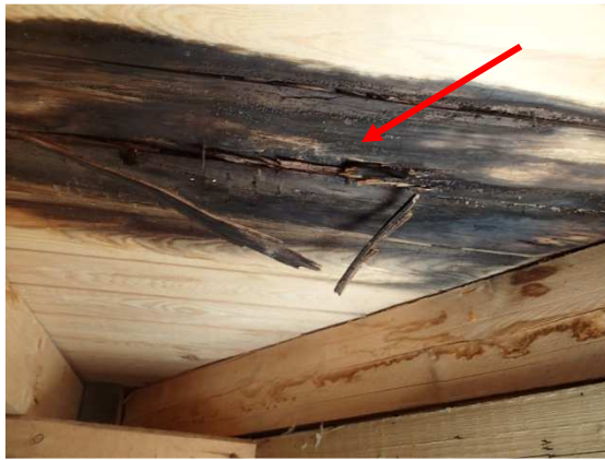
Kuva 15. D-osa, vesikatevuodon aiheuttamia lahonneita ruodelautoja.
