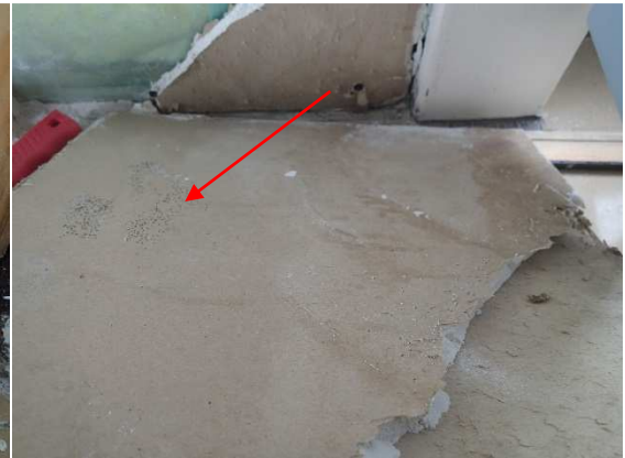
Kuva 14. Kipsilevyn ulkopinnassa mikrobikasvustoa
