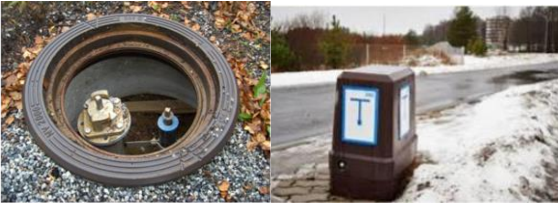
Kuva 1 & 2: Maanalainen palopostirakenne ja maanpäällinen palovesiasema.
