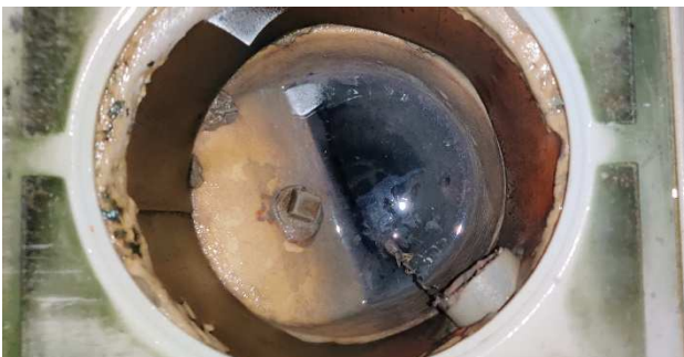
Kuva 20. Pesutilojen lattiakaivot ja viemärit ovat todennäköisesti alkuperäisiä ja valurautaisia. Kaivot ovat teknisen käyttöikänsä lopussa.
