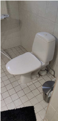
Kuva 16. WC -tilat saneerattu 2000 -luvulla. Pintaraketeet hyväkuntoiset.
