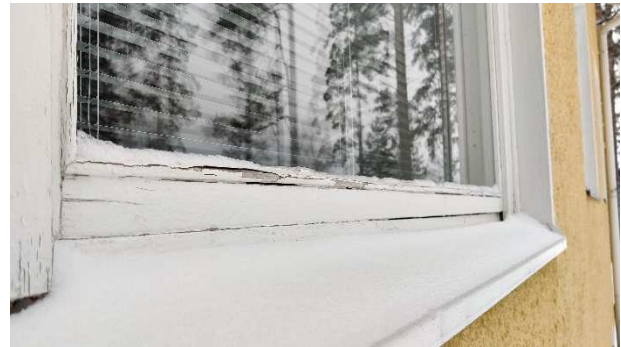
Kuva 5. Ikkunoiden ulkokarmit ovat paikoin huonokuntoiset ja maali hilseilee irti. Kuva takapihan puoleisesta ikkunasta (makuuhuone).
