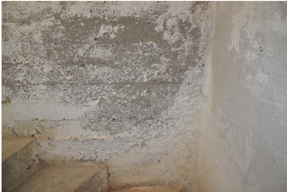
Kellarikerroksen portaikossa perusmuurin läpi tulevaa kosteutta.
