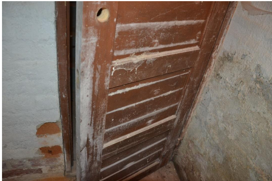
Kosteusvaurioitunut keittiön alapuolisen osakellarin väliovi.
