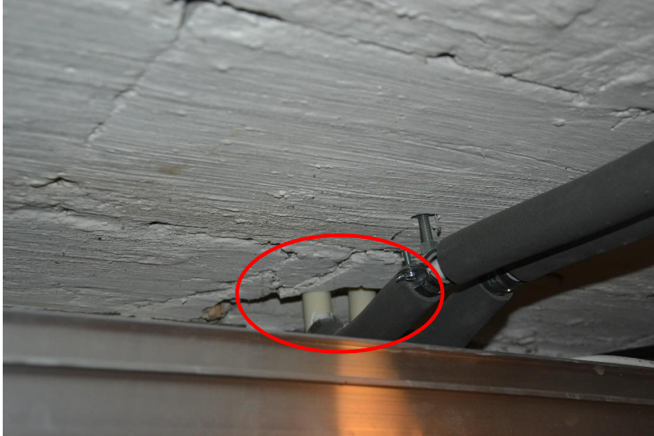
Esimerkkikuva kellarista asuintiloihin tulevasta epätiiviestä läpivienneistä.
