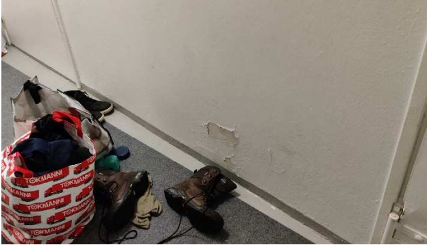
Kuva 28. Kellarin käytävä. Kellarin seinien alaosissa tasoite- ja maalikerrokset irtoilevat paikoin alustastaan, ja seinien alaosissa havaittavissa pintakosteutta. Havainnot viittaavat siihen, että rakenteisiin nousee kapillaarisesti kosteutta maaperästä.
