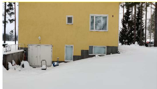
Kuva 7. Rakennus sijaitsee loivassa rinteessä. Päädyistä on käynti autotalliin. Maanpinnan muotoilu kerää paikoin sade- ja sulamisvesiä rakennuksen vierustalle.
