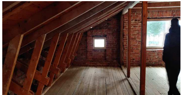
Kuva 25. Ullakkotilassa on ikkunat. Tila on pääasiassa siisti, eikä viitteitä puutteellisesta tuuletuvuudesta.
