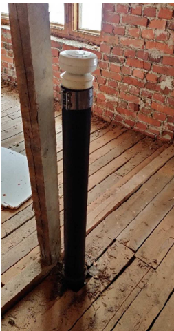
Kuva 26. Viemärin tuuletus uusittu muoviputkella, ja päättyy ullakolle: putken pää varustettu alipaineventtiilillä. Määräysten mukaisesti viemärin tuuletus tulisi jatkaa vesikatolle saakka.
