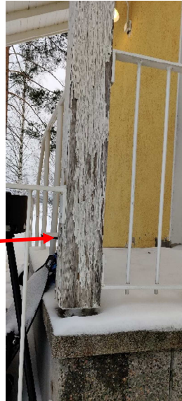
Kuva 11. Terrassin puurakenteissa on paikoitaisia vaurioita. Kuva takaterassin kantavasta puupilarista.
