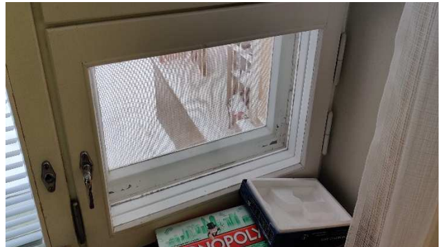
Kuva 15. Ikkunat ovat 3-lasisia puuikkunoita. Ikkunoissa on huoltomaalaustarvetta.
