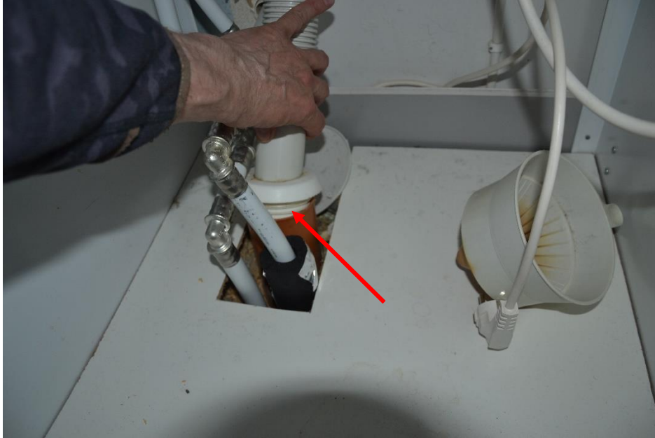
Esimerkkikuva 3 epätiivistä viemäriputken liitoksesta yläkerran laajennusosan päätymakuuhuoneesta.
