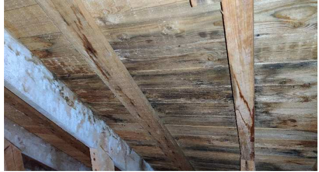
Kuva 23. Kattopohjalaudoituksessa on nähtävillä vanhoja vesivuotojälkiä paikoittaisesti. Laudoituksissa paikoittaisia vaurioita.
