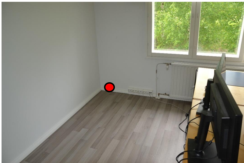
8.1.Toimisto, pesuhuoneen viereinen huone: Ikkunan molemmin puolin ulkoseinän nurkkaukset.
