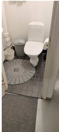
Kuva 39. Kellarin wc-tila on saneerattu 2000-luvulla. Lattiapinnoitteena on pienikokoinen klinkkerilaatta, joka mahdollistaa maaperäkosteuden kulkeutumisen ylöspäin.
