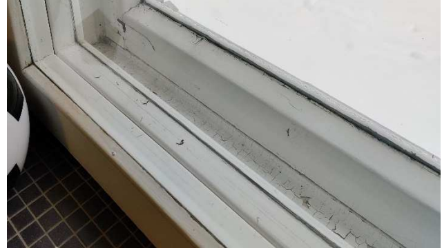
Kuva 3. Ikkunoissa huoltotarvetta, maali hilseilee paikoin irti.
