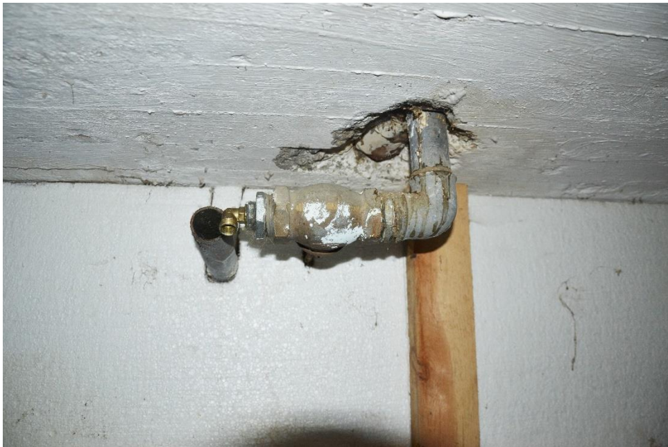
Esimerkkikuva laajennusosan kellarista ylös nousevista epätiiviviistä läpivienneistä.
