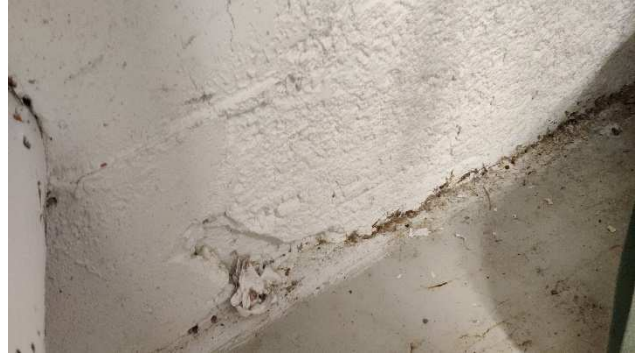
Kuva 29. Kellarin varastotila. Kellarin seinien alaosissa tasoite- ja maalikerrokset irtoilevat paikoin alustastaan, ja seinien alaosissa havaittavissa pintakosteutta. Havainnot viittaavat siihen, että rakenteisiin nousee kapillaarisesti kosteutta maaperästä.
