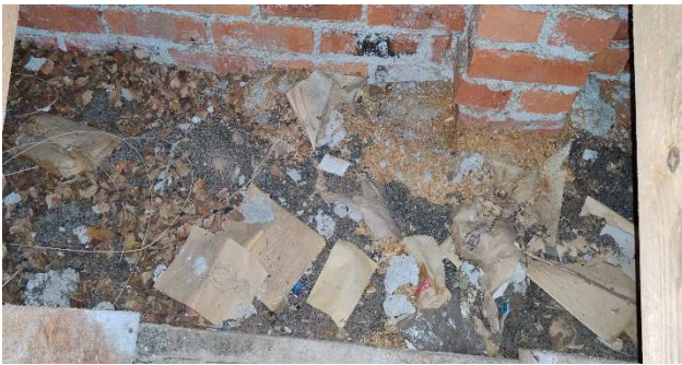
Kuva 24. Yläpohjan lämmöneristeenä muhaa (kutterilastua/hiekkaa/turvetta ym.), mikä on rakentamisajalle tyypillistä. Yläpohjassa myös jonkin verran roskaa ja puunlehtiä.
