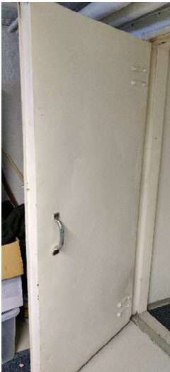
Kuva 38. Kellarin alkuperäiset palo-ovet sisältävät asbestia.
