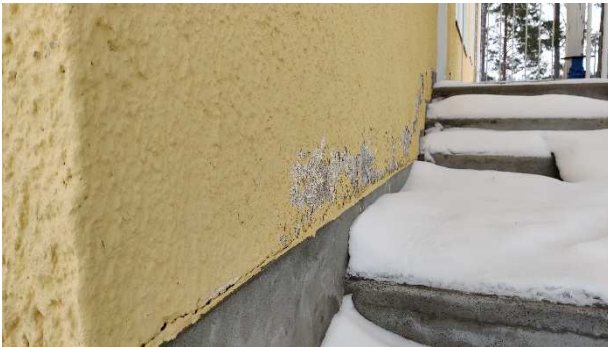
Kuva 4. Julkisivun pinnoite hilseilee paikallisesti takapihan puoleisen terassin portaiden kohdalla. Rakenteeseen pääsee paikallisesti kulkeutumaan kosteutta.
