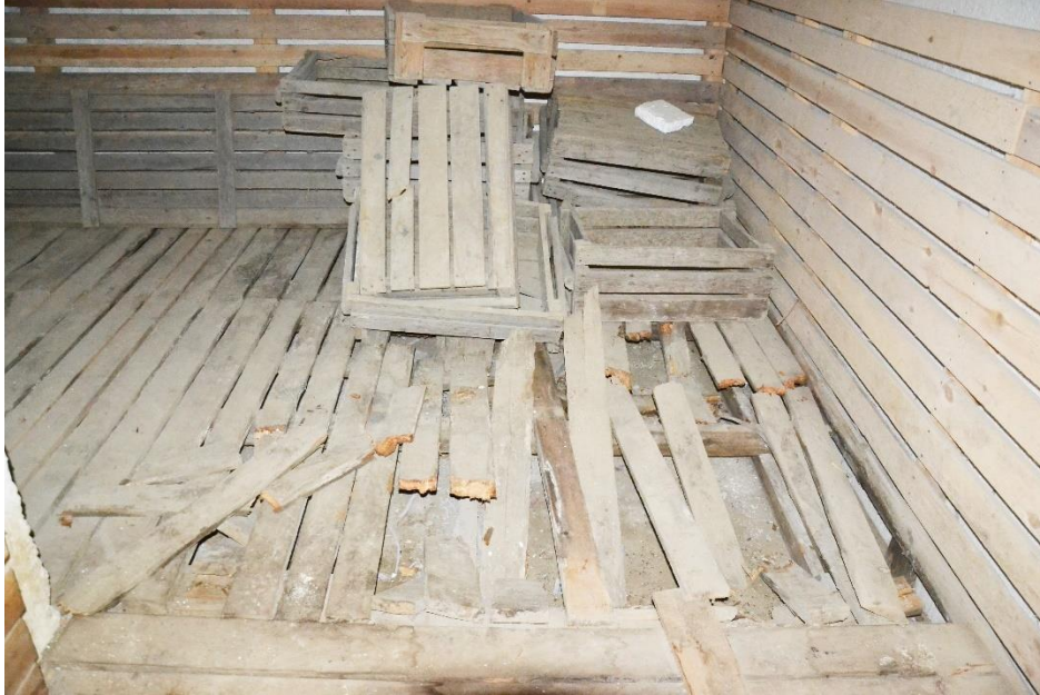
Laajennusosan kellaritiloissa olevaa kosteus- ja osin lahovaurioitunutta puurakennetta.
