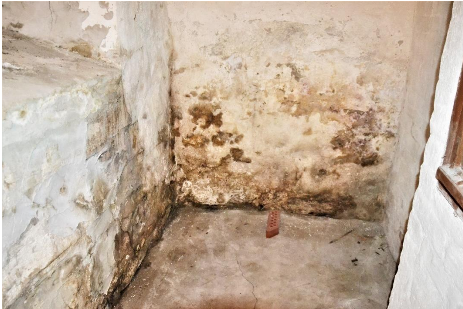
Keittiön alapuolelta osakellarin seinäpintojen kosteus- ja homevauriota.
