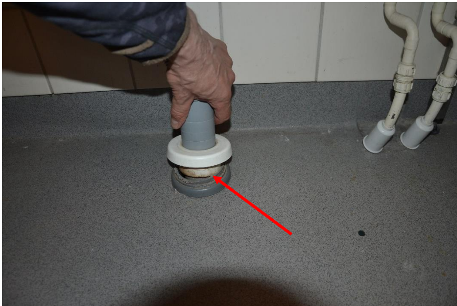
Esimerkkikuva 2 epätiiviestä viemäriputken liitoksesta salin vierisestä kodinhoituhuoneesta.
