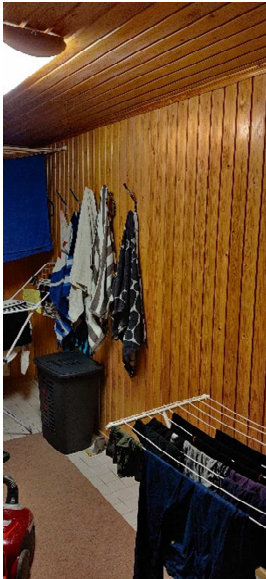
Kuva 42. Kellarin pukuhuoneen maanvastaisessa seinässä on paneeliverhous. Verhouksen takana on puukoolaus ja mahdollinen eriste, mikä tekee rakenteesta riskialttiin.
