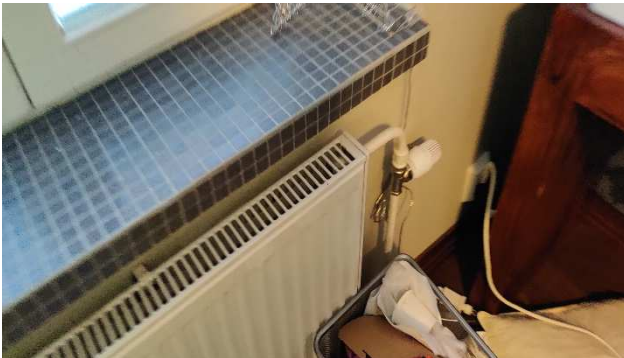
Kuva 14. Patterit ja patteritermostaatit uusittu 2000-luvulla.
