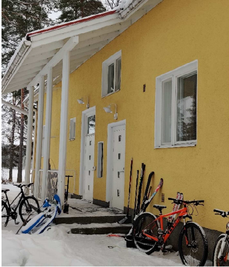
Kuva 40. Rakennuksen ulko-ovet on uusittu ja ne ovat hyväkuntoiset. Sisäänkäyntikuisti peruskuntonen.
