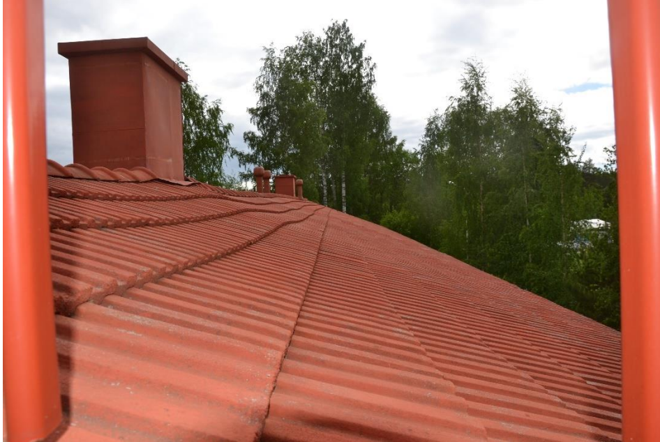
Piippujen päältä puuttuvat hatut ja katteen poimuilua.
