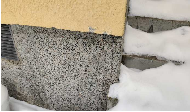
Kuva 8. Sokkelissa on paikoin pieniä halkeamia. Sokkelin pinnoitteena on pesubetonilaatta.
