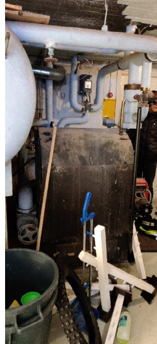
Kuva 33. Vanha öljylämmityskattila on varalämmönlähteenä.
