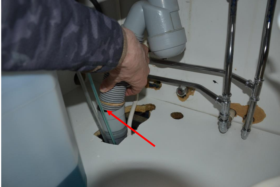
Esimerkkikuva 1 epätiiviestä viemäriputken liitoksesta.
