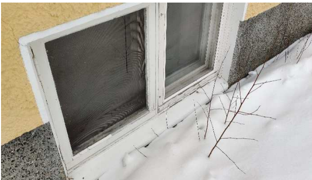
Kuva 6. Kellarin ikkunat ulottuvat lähelle maanpinnan tasoa. Tästä johtuen ikkunan alakarmeihin kohdistuu ajoittain voimakasta kosteusrasitusta.
