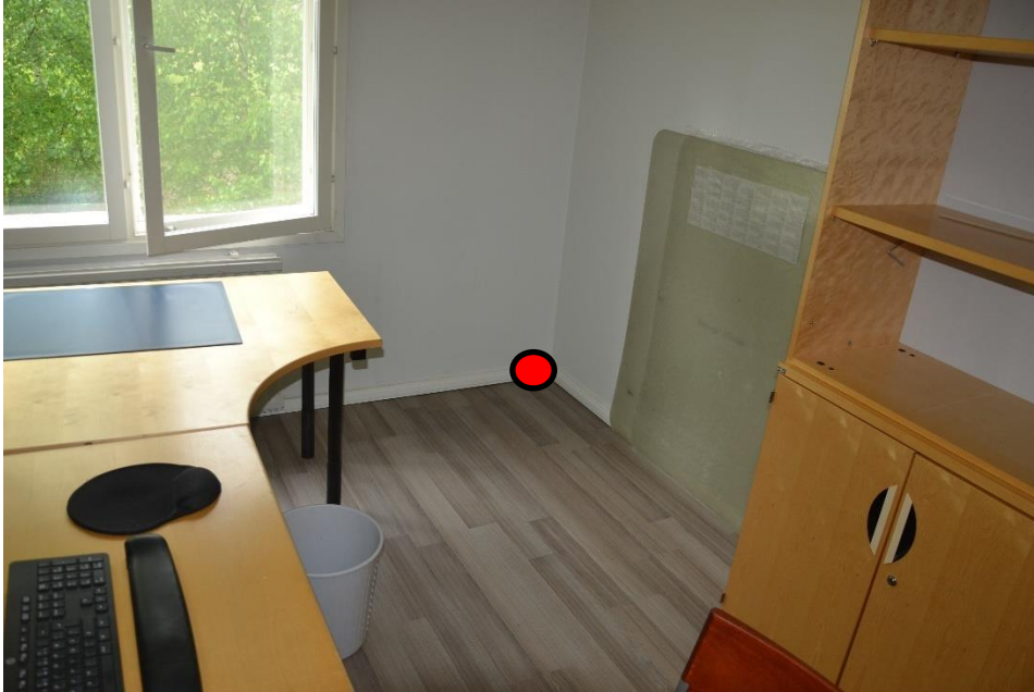
8.2.Toimisto, pesuhuoneen viereinen huone: Ikkunan molemmin puolin ulkoseinän nurkkaukset.
