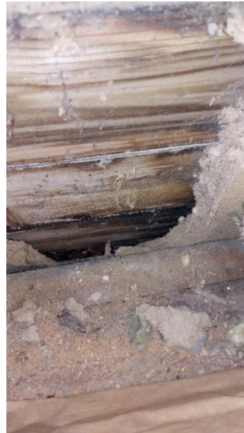
Kuva 15. Julkisivun alaosaan kosteus- ja lahovaurioita.
