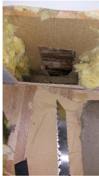
Kuva 13. Laajennusosalle tehdyssä rakenneavauksessa oli aistittavissa vaurioon viittaavaa hajua. Kosteusjälkiä havaittiin seinän alaosaan.
