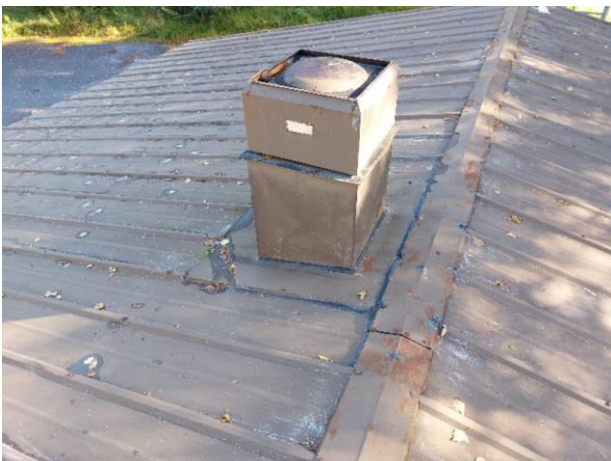
Kuva 34. Vesikaton kunto on heikko.
