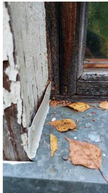
Kuva 7. Ikkunapellitysten tiiveys heikko.
