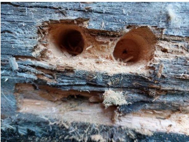
Kuva 24. Hirsiseinässä olevat lahot ovat rakenteen pinnassa, koeporareissä ei havaittu lahoa syvemmillä rakenteessa.
