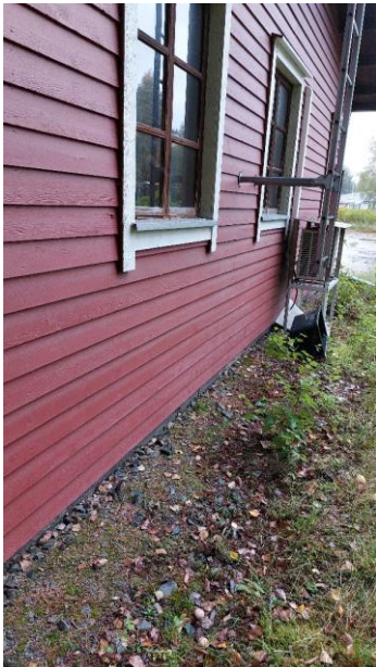
Kuva 10. Julkisivun maalipinnoite on paikoin kun- nossa.
