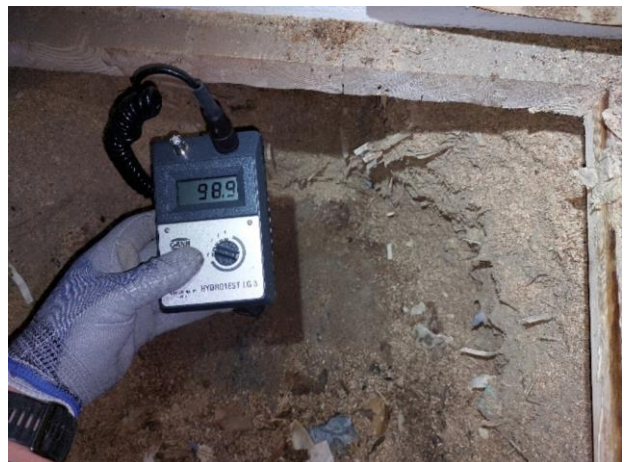
Kuva 67. Roskavalulaatan päältä mitattiin koholla olevaa pintakosteutta.
