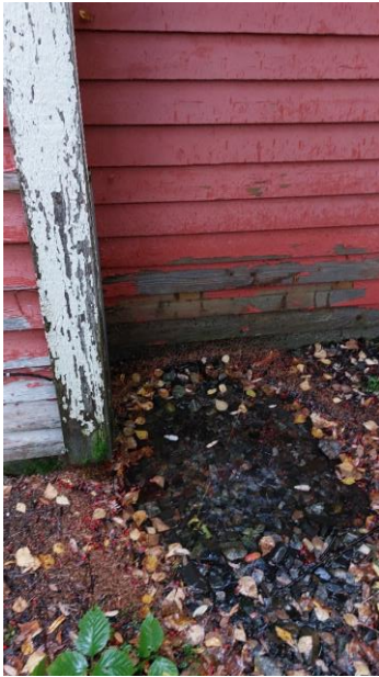
Kuva 12. Takapihalla rakennusosien välissä seinän alaosaan kosteusjälkiä, sisäpuolelta rakenneavaus tehtiin ko. kohtaan.
