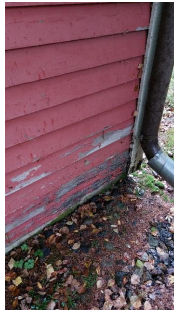
Kuva 11. Puutteet sadevesien poistoissa on lisännyt julkisivun ja seinien alaosien kosteusrasitusta.
