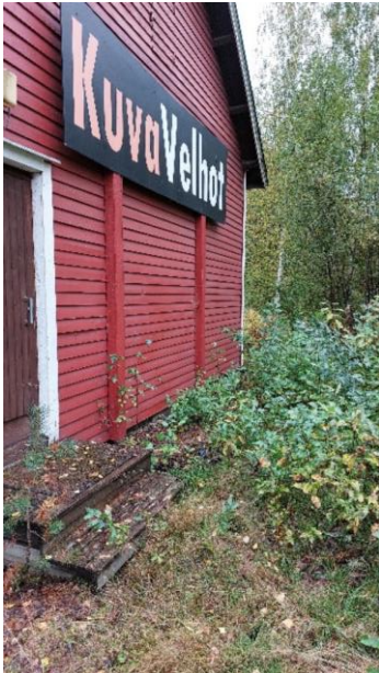
Kuva 4. Julkisivujen maalipinta on osin normaali- ja osin heikkokuntoinen.
