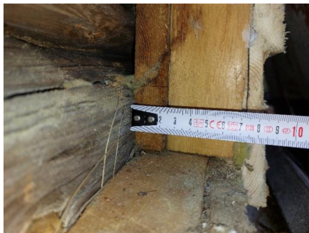
Kuva 29. 5 cm paksu lisäkoolaus asennettu suoraan kiinni hirsiseinään, osittain koolausta on oikaistu laudoituksella. Julkisivu ei tuuletu.
