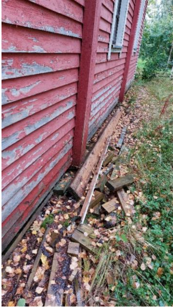
Kuva 8. Alkuperäisen rakennusosan julkisivu ei tuu- letu.
