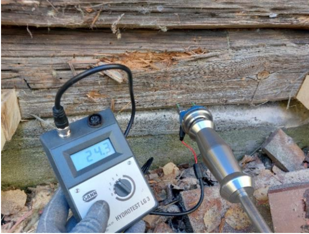
Kuva 30. Hirsiseinän alaosissa kosteudet koholla.
