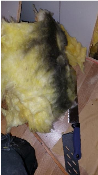
Kuva 14. Lämmöneristeet tummuneet alaosistaan. Villassa mikrobiperäinen haju.
