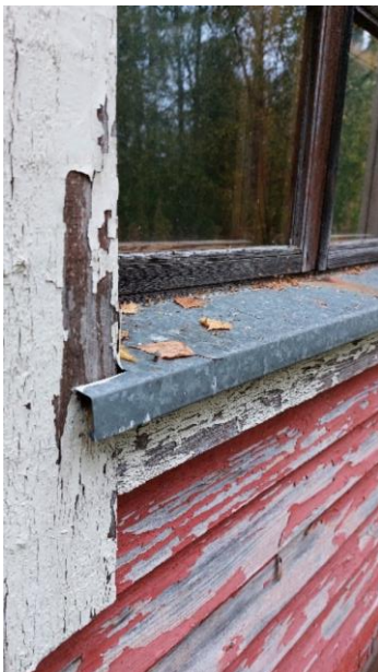
Kuva 6. Ikkunoiden ulkokarmit ovat paikoin huono- kuntoiset ja maali hilseilee irti. Kuva takapihan puolei- sestä ikkunasta (makuuhuone).
