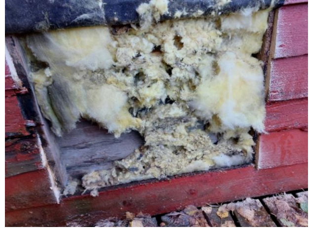
Kuva 21. Hirsiseinän sisäpintaan on asennettu mineraalivillaa, villassa mikrobiperäinen haju.
