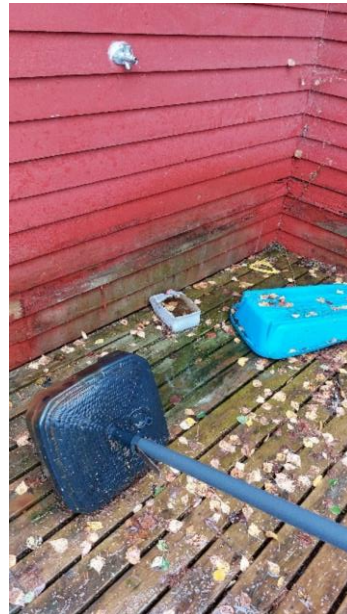
Kuva 3. Etupihan sisänurkkauksessa kosteuden aiheuttamia jälkiä ulkoseinän alaosissa.
