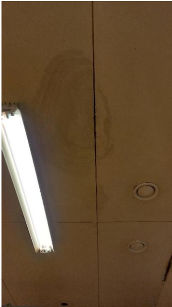
Kuva 60. Alkuperäisen rakennusosan alakatossa van- hoja kosteusjälkiä huippuimurin kohdalla.
