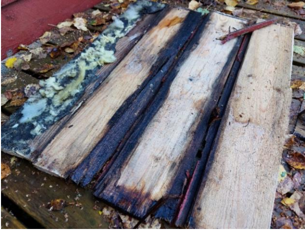
Kuva 20. Etupihan sisänurkan julkisivun alaosat ovat kosteusvaurioituneet.
