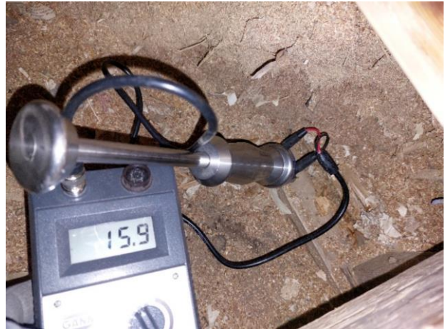
Kuva 71. Koolausrakenteissa kosteus- pitoisuudet ovat koholla.
