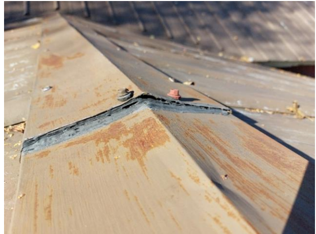
Kuva 37. Massaukset halkeilleet ja epätiivit.
