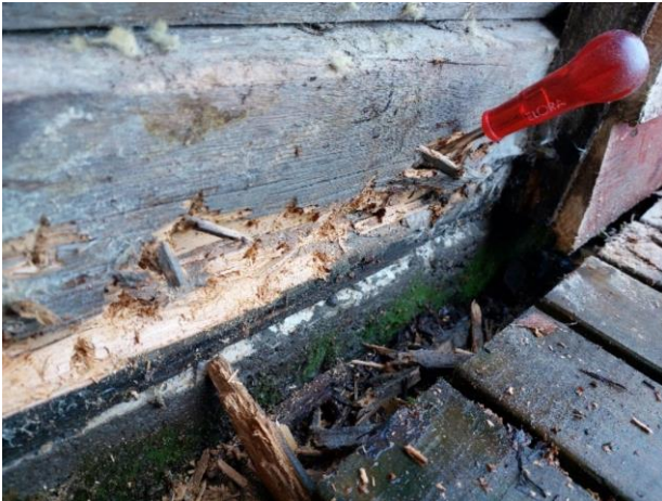
Kuva 22. Hirsiseinän alaosissa lahovaurioita.
