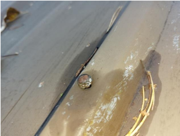
Kuva 36. Kiinnikkeiden kautta kulkeutuu vettä ylä- pohjatilaan.
