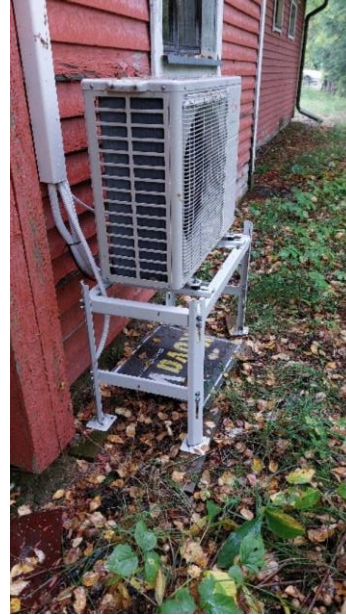
Kuva 9. Sähkölämmityksen lisäksi tiloissa on ilma- lämpöpumput.
