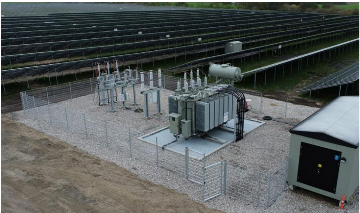
Kuva 17. Vastaavan voimalaitoksen muuntamoalue ja paneelikenttiä.
