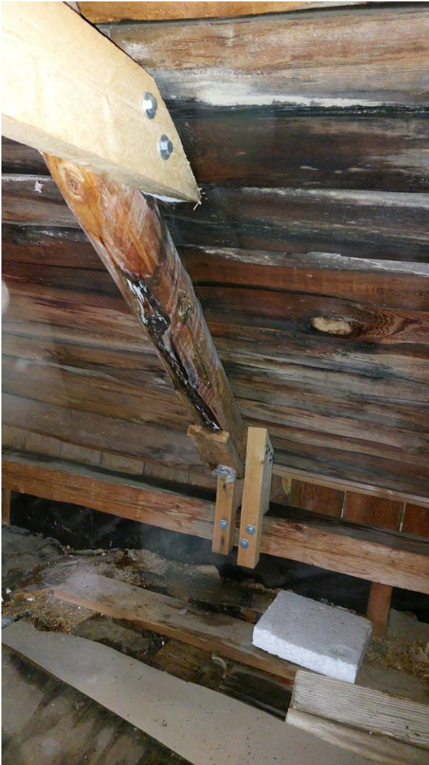
Kuva 21. Katon kautta vuotanut vettä. Puurakenteissa paikallisia kosteusvaurioita.
