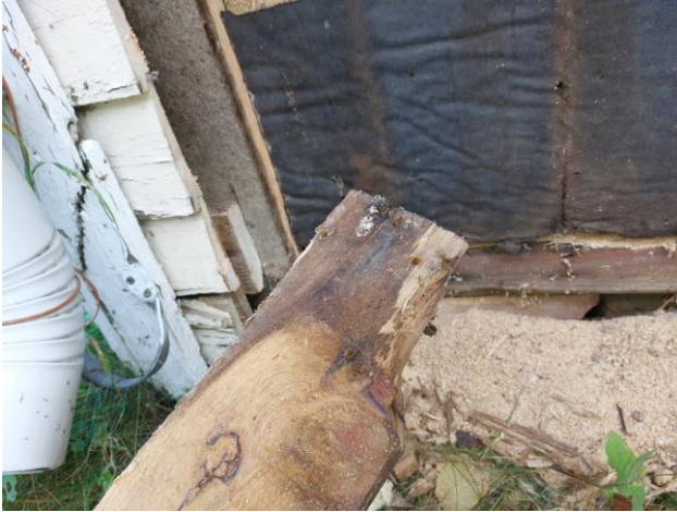
Kuva 10. Julkisivulaudoituksen takana kosteuden aiheuttamia jälkiä.
