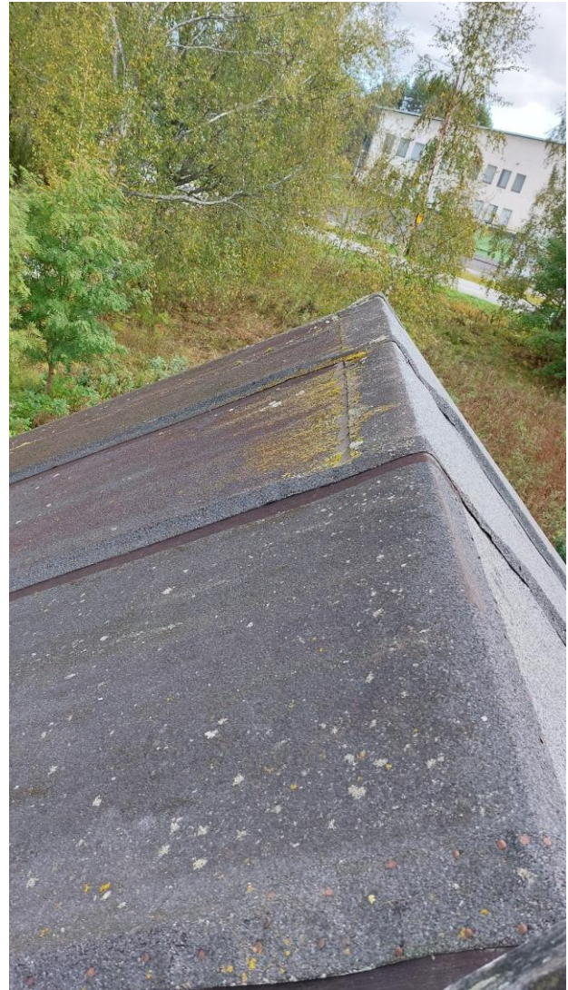
Kuva 16. Huopakatteen liitokset epätiivtiit.
