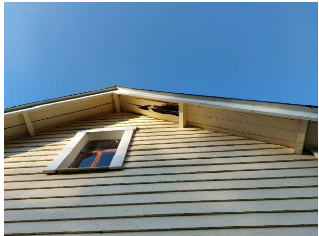
Kuva 9. Räystäslaudoituksissa näkyvissä kosteuden aiheuttamia jälkiä.
