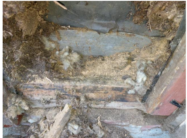
Kuva 25. Seinän alaosissa vaurioon viittaavaa hajua ja lahovaurioita.
