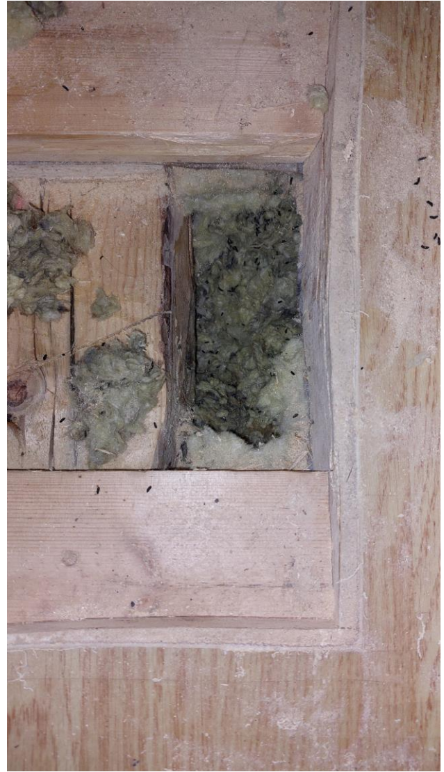
Kuva 27. Alapohjassa mineraalivillaeristys, avauksessa voimakas mikrobiperäinen haju.
