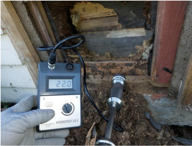
Kuva 26. Puurungon alaosissa kosteuspitoisuus mittaushetkellä yli 20 p%, joka mahdollistaa lahovauriot.
