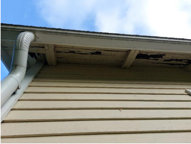
Kuva 12. Räystäslaudoituksissa näkyvissä kosteuden aiheuttamia jälkiä.
