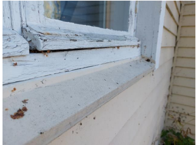
Kuva 7. Ikkunapellitusten tiiveys huono.
