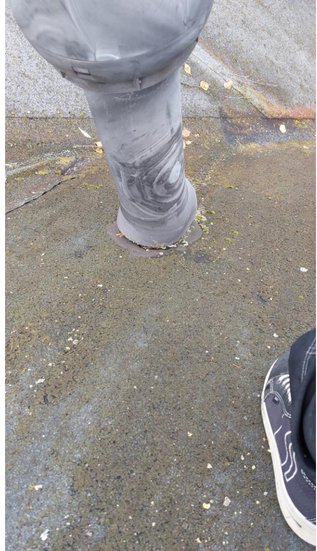
Kuva 14. Läpiviennin tiiveys puutteellinen.
