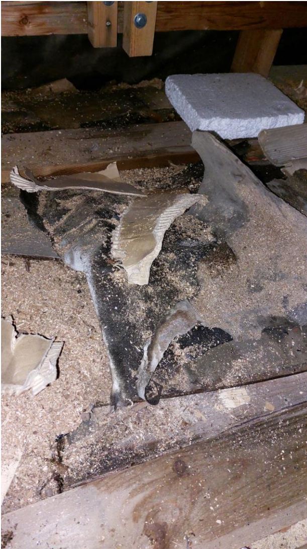
Kuva 23. Yläpohjassa purueristys. Tervapaperissa kosteuden aiheuttamia jälkiä.
