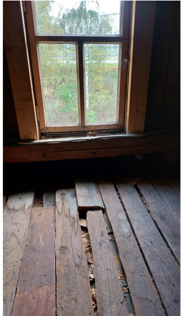
Kuva 22. Ullakkotilan ikkunoiden edustalla vuotojälkiä.
