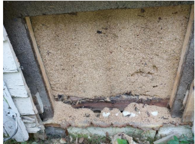
Kuva 5. Ulkoseinässä purueristys. Eristeissä aistittavissa selkeää mikrobiperäistä hajua.
