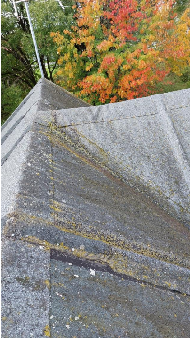
Kuva 13. Yleiskuva vesikatteesta. Bitumikate on uusittu 80-luvulla. Katolla havaittavissa sammalta.
