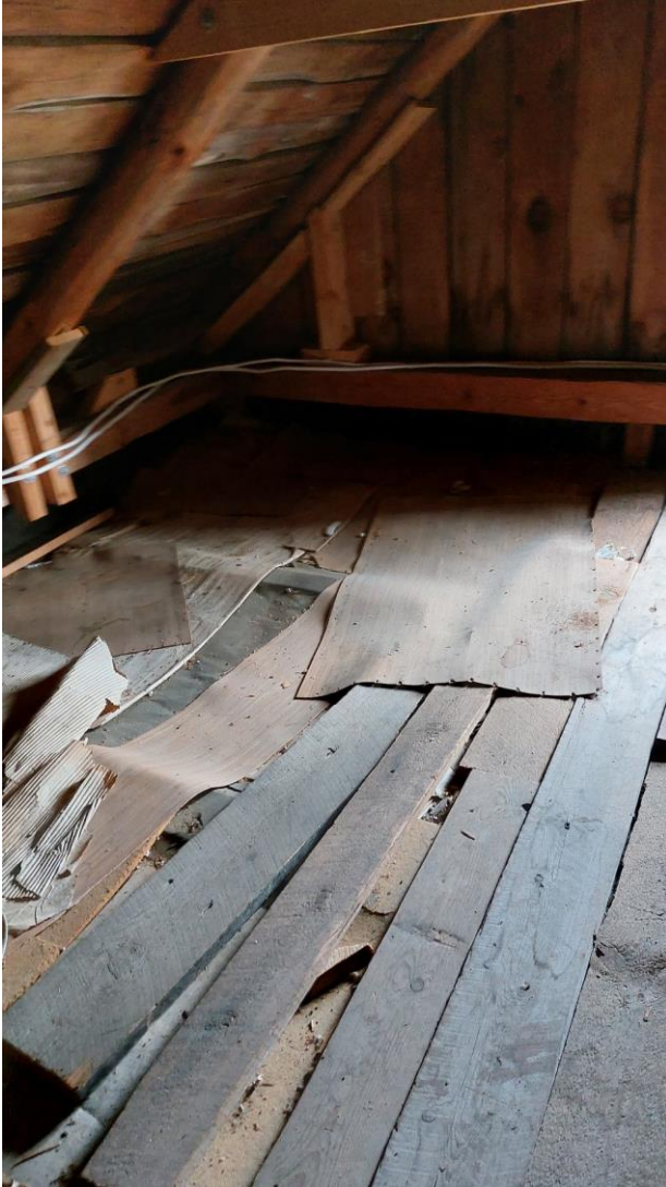
Kuva 19. Laudoituksen lisäksi yläpohjan eristeiden päällä vanhaa muovimattoa ym. rakennusmateriaalia.
