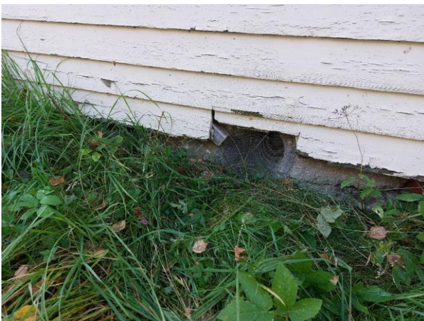
Kuva 10. Rossipohjaan tehty tuuletusaukkoja. Julkisivun alaosissa kosteuden aiheuttamia jälkiä.
