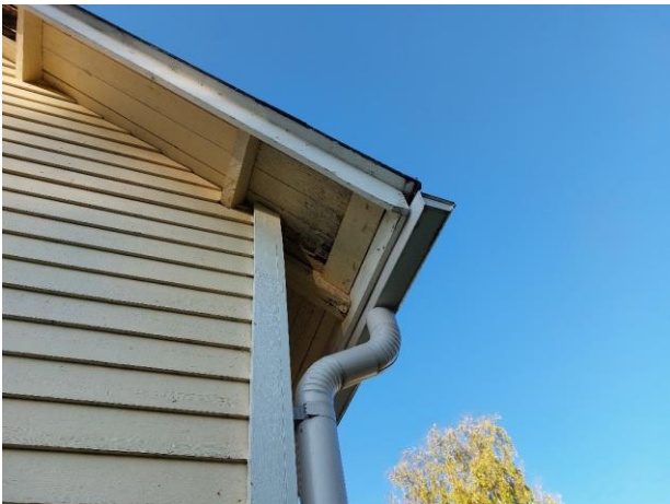
Kuva 8. Räystäslaudoituksissa näkyvissä kosteuden aiheuttamia jälkiä.
