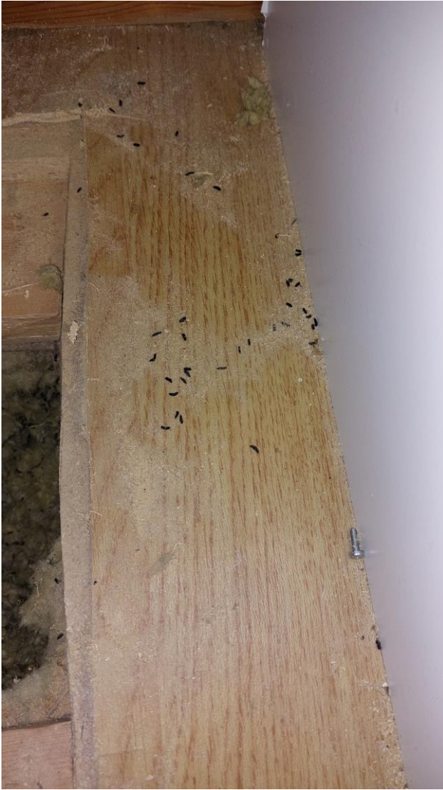
Kuva 26. Alapohjan rakenneavaus AP-RT1 tehtiin eteiseen. Eristeen yläpinnassa jyräjoiden ulostetta.
