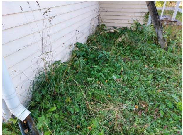
Kuva 5. Ulkopuolien kasvillisuus lisää merkittävästi seinien alaosien kosteusrasitusta. Etupihalla aistittavissa mikrobiperäistä hajua jonka lähteenä toimii seinien ja alapohjarakenteiden lahovauriot.
