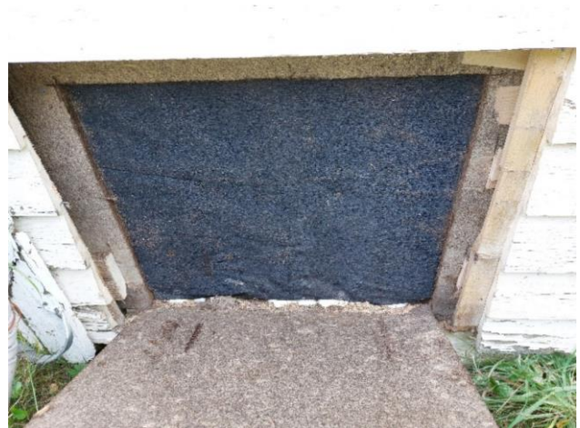
Kuva 3. Julkisivuverhouksen ja tuulensuojalevyn takana tervapaperi.
