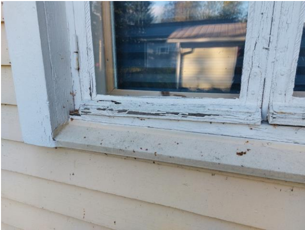
Kuva 6. Ikkunoiden ulkopuutteet huonokuntoiset.
