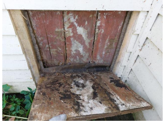
Kuva 12. Tuulensuojan ja vanhan julkisivun välissä kosteuden aiheuttamia jälkiä.
