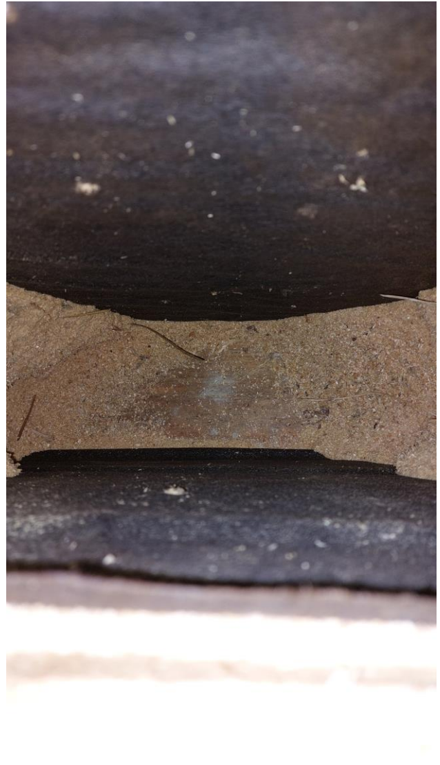
Kuva 19. Alaohjauspuussa näkyvissä kosteuden aiheuttamia jälkiä, purueriste kostea seinän alaosissa.
