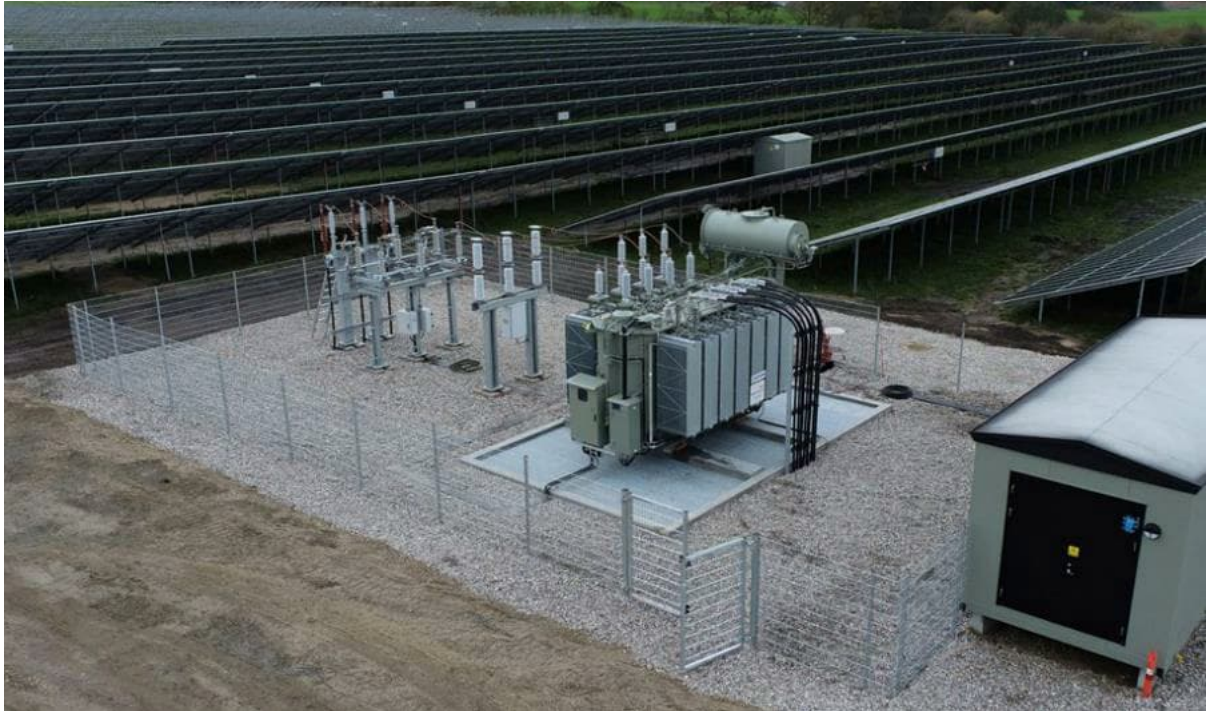
Kuva 17. Vastaavan voimalaitoksen muuntamoalue ja paneelikenttiä.
