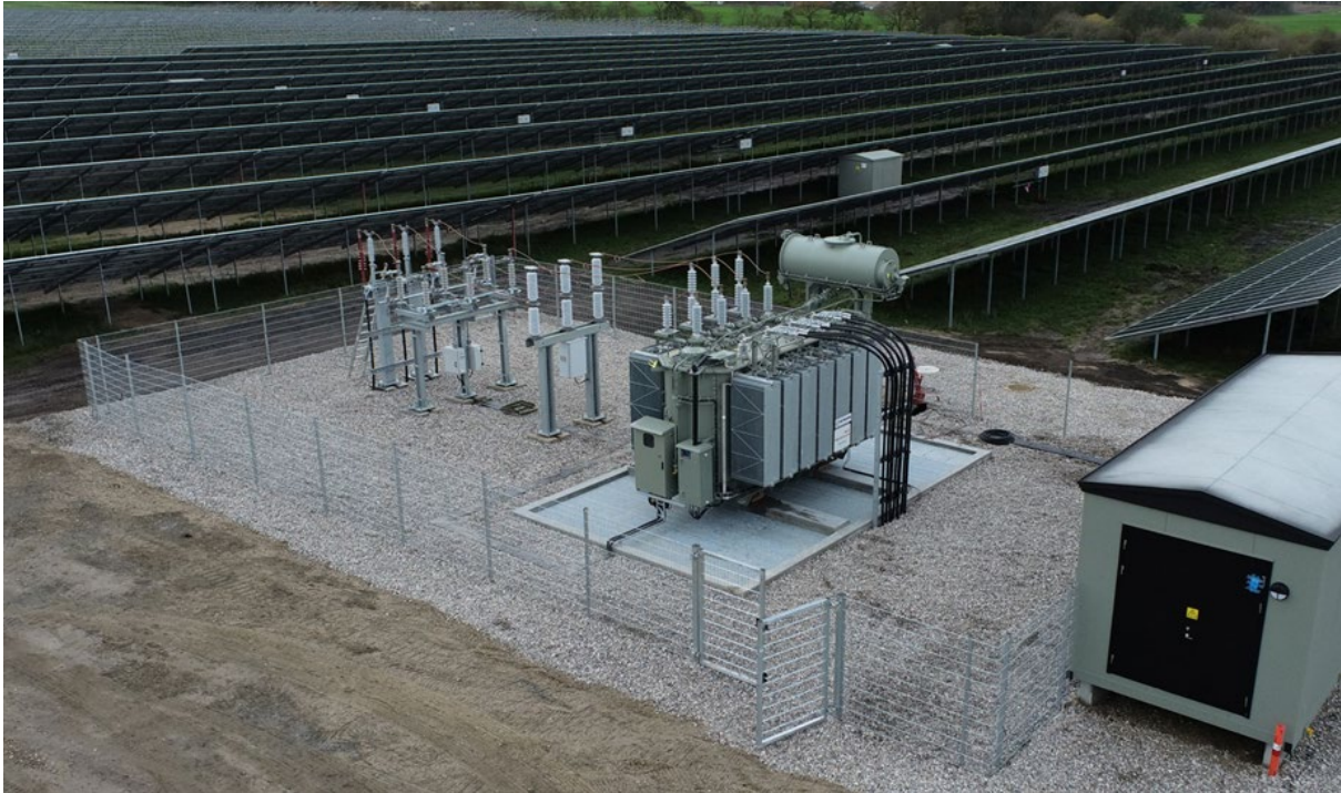
Kuva 5. Vastaavan voimalaitoksen muuntamoalue ja paneelikenttiä.
