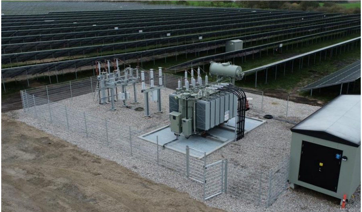
Kuva 17. Vastaavan voimalaitoksen muuntamoalue ja paneelikenttiä.
