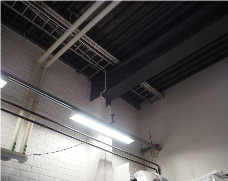
Päätytiiliseinää vasten on sijoitettu betonipilari, jonka päällä on primäärikannakkeena toimiva teräspalkki. Sisäkaton verhoilu on peltiä.
