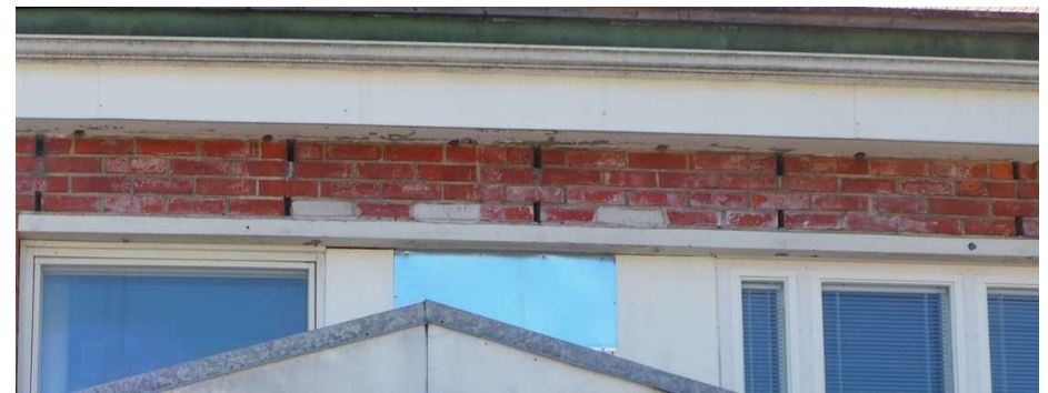
Vesikaton valumavedet ovat vaurioittaneet ulkoisesti tiilipintaa. Näkyvissä myös korjattuja tiiliä.
