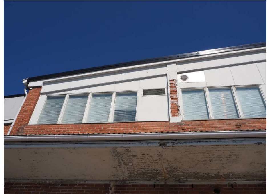
Rakennuksen länsipuolella sijaitsevien toisen kerroksen ikkunoiden väleissä olevat pilasterit ovat vaurioituneet vuosien saatossa. Muutoin julkisivut ovat pääosin siistissä kunnossa.
